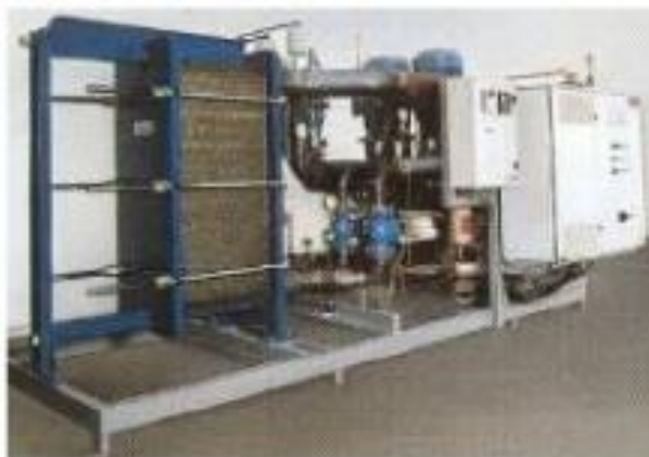
Εικόνα 2.6.4 Υποσταθμός τηλεθέρμανσης σε κτίριο
