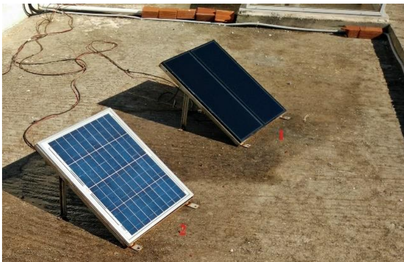
Εικόνα 61: Φωτοβολταϊκά πλαίσια πειράματος
