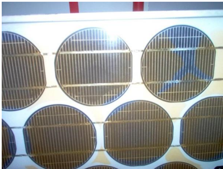
Εικόνα 39: Γήρανση σε φωτοβολταϊκό πλαίσιο μετά από πολυετή χρήση, λόγω σκίασης. Παρατηρείται το ξεθώριασμα του μπλε χρώματος, καθώς και η οξείδωση στους μεταλλικούς αγωγούς.
