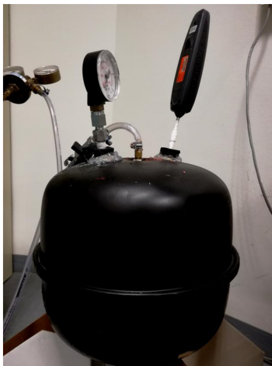
Σχήμα 7: Δοχείο διαστολής χωρητικότητας 12 lt μετά την τοποθέτηση μανόμετρου μέτρησης σχετικής πίεσης και του αισθητήρα Pt 100.
