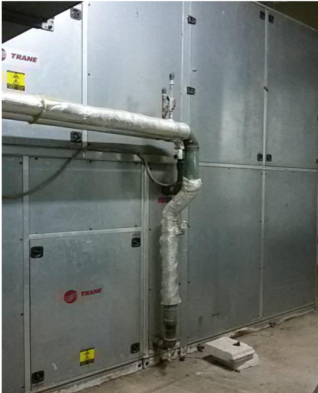
Εικόνα 5.9: Χώρος επεξεργασίας εξωτερικού αέρα των ΚΚΜ.
