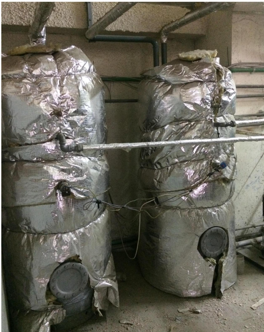
Εικόνα 5.8: Boiler αποθήκευσης ζεστού νερού χρήσης.
