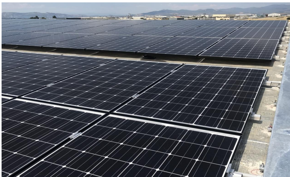
Εικόνα 7.3: Φωτοβολταϊκά συστήματα που τοποθετούνται στην οροφή.
