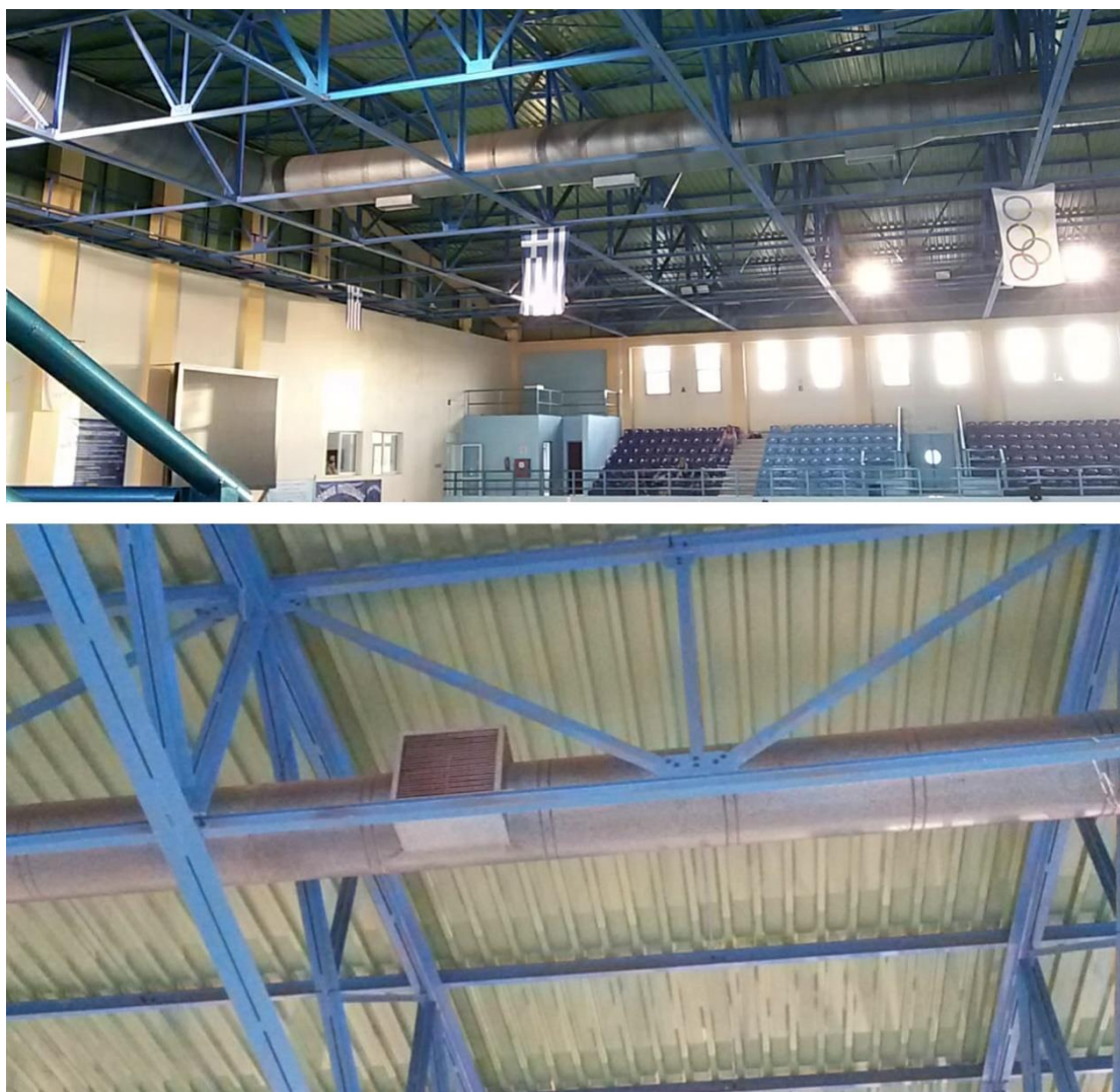
Εικόνα 5.10: Δίκτυο αεραγωγών και στόμιο προσαγωγής αέρα στην οροφή του κολυμβητηρίου.
