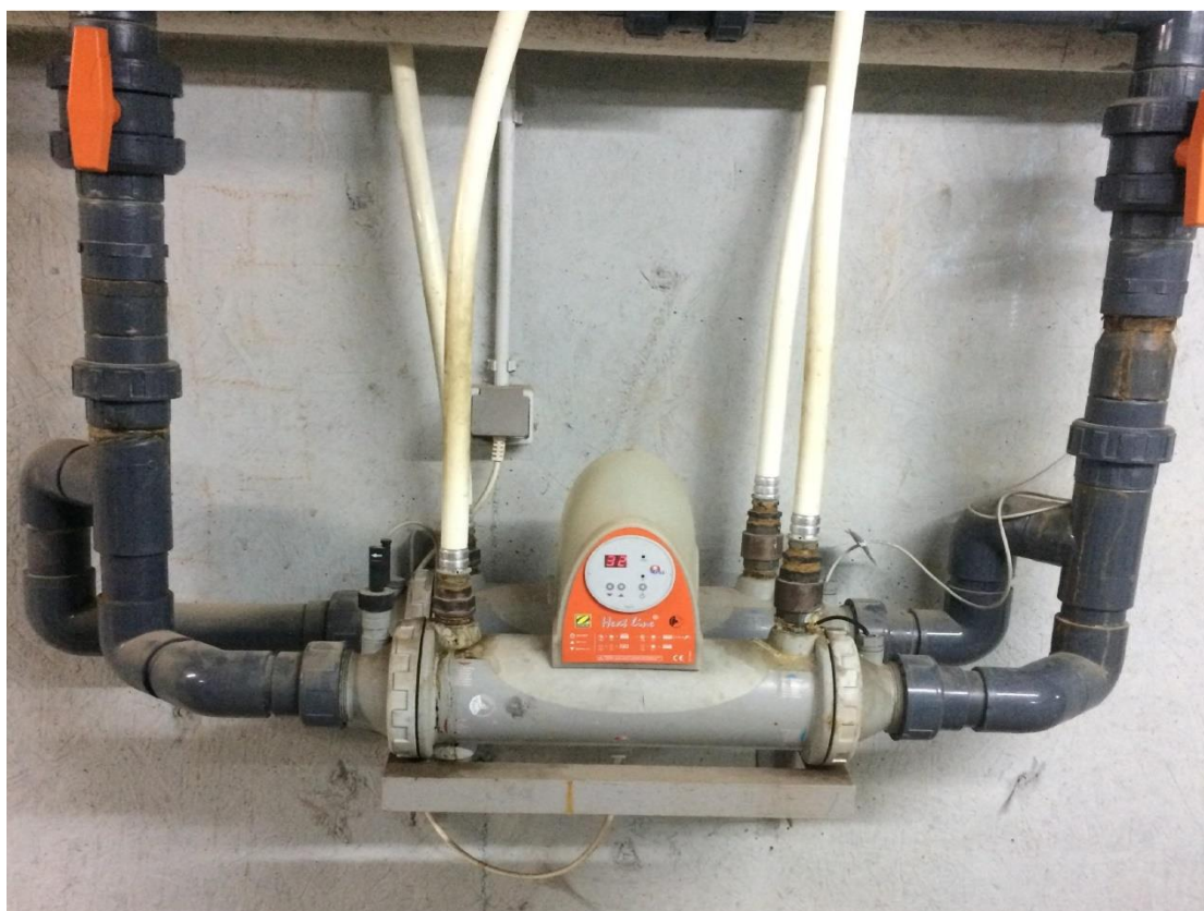
Εικόνα 5.5: Εναλλάκτης θέρμανσης νερού πισινών τύπου ZODIAC HEAT LINE.
