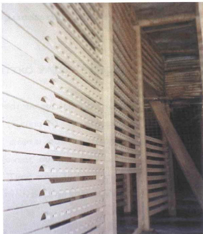
Σχήμα 4 Χρήση αμιαντοσιμέντου ως πληρωτικό υλικό σε πύργο ψύξης
