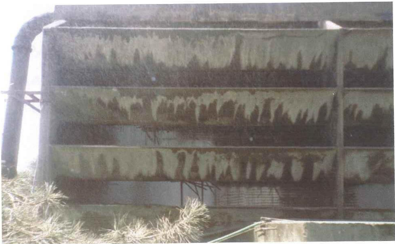
Σχήμα 39 Το κατεστραμμένο πληρωτικό υλικό σε ένα από τα έξι κελιά των πύργων ψύξης της μονάδας του ΑΗΣ ΛΙΠΤΟΛ (2)
