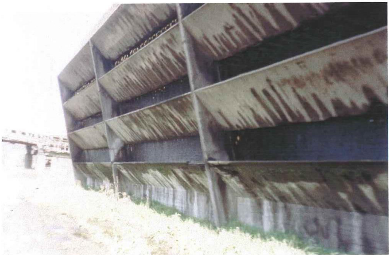
Σχήμα 35 Η εγκατάσταση των πύργων ψύξης της μονάδας του ΑΗΣ ΛΙΤΠΤΟΛ (3)
