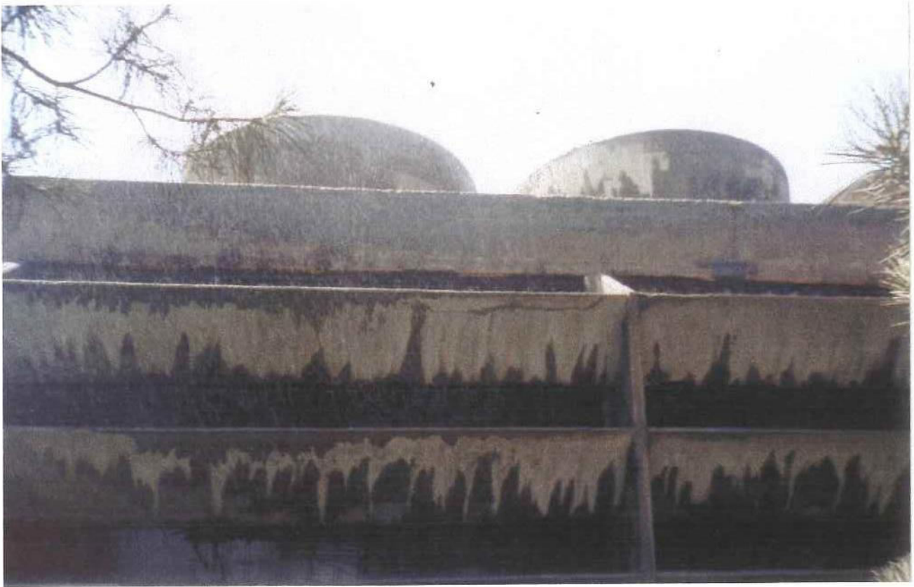
Σχήμα 34 Η εγκατάσταση των πύργων ψύξης της μονάδας του ΑΗΣ ΛΙΤΠΤΟΛ (2)
