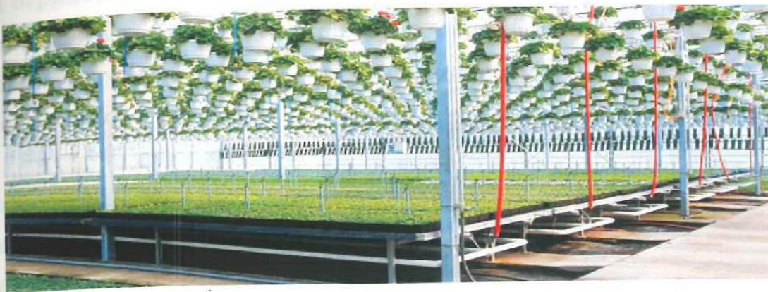
Σχήμα 3.14: Θέρμανση κάτω από πάγκους, με σωλήνες ζεστού νερού.
