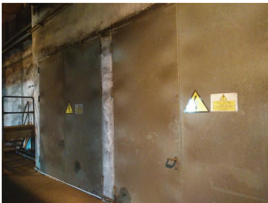
Εικόνα 3.10. Σήμανση Προειδοποίησης Σε Ηλεκτρικό Κύκλωμα
