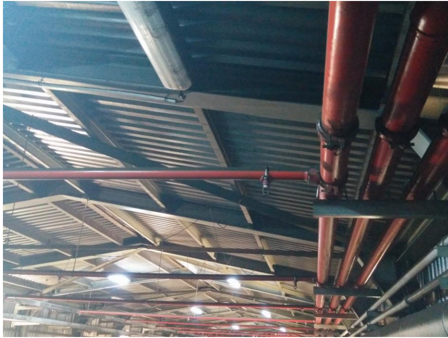
Εικόνα 3.13. Αυτόματο Σύστημα Κατάσβεσης
