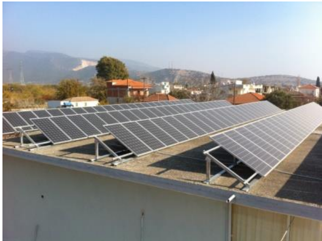
Εικόνα 1.15: Φωτοβολταϊκά σε Πολυκατοικία
