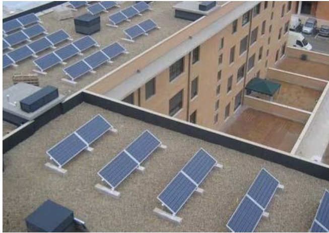
Εικόνα 1.14: Φωτοβολταϊκά σε Πολυκατοικία
