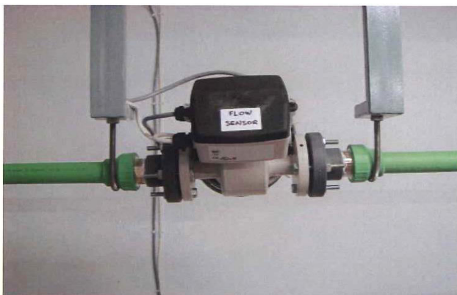
Εικόνα 2: Μετρητής ροής νερού SIEMENS MAG 5100
