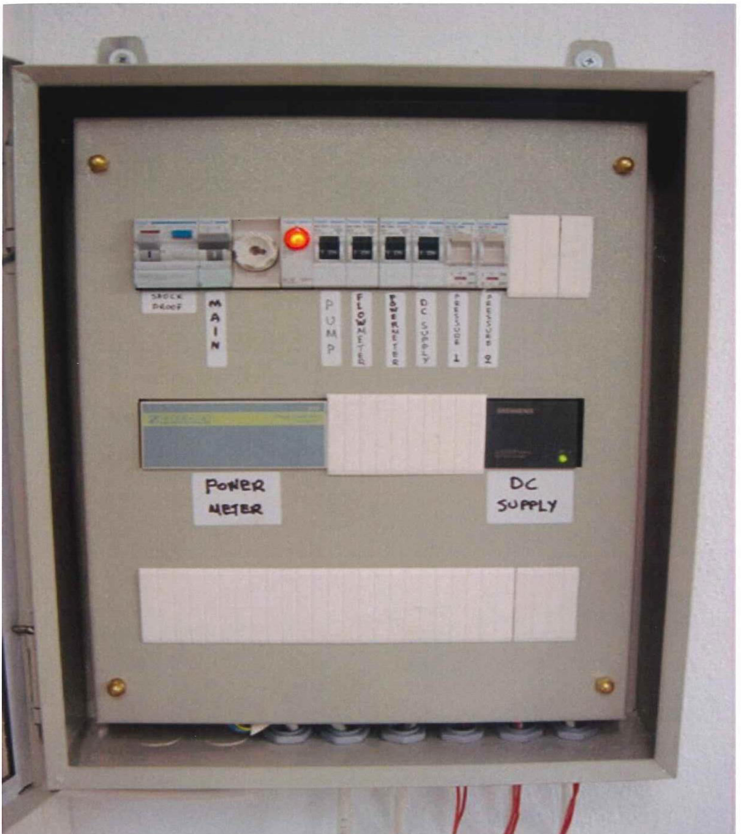
Εικόνα 14: Ηλεκτρικός πίνακας παροχής ρεύματος
