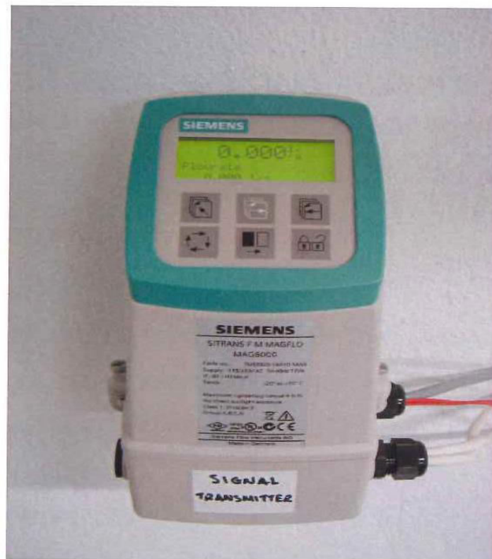
Εικόνα 3: Μεταδότης σήματος SIEMENS MAG 6000 για τον μετρητή νερού
