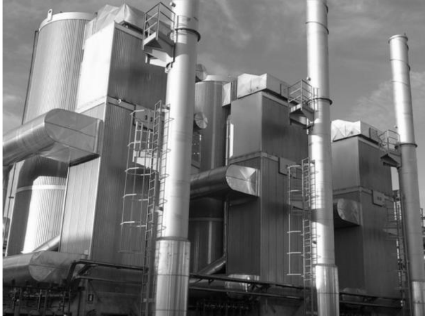
Εικόνα 16: Άποψη από βοηθητικούς λέβητες υβριδικών σταθμών [19]
