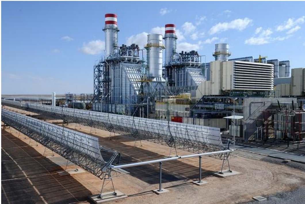
Εικόνα 18: Ο σταθμός Ain Beni Mathar στο Μαρόκο [39]
