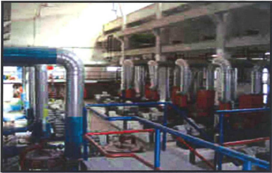
Εικόνα 12: Αντλιοστάσιο Α3 Τηλεθέρμανσης Κοζάνης
