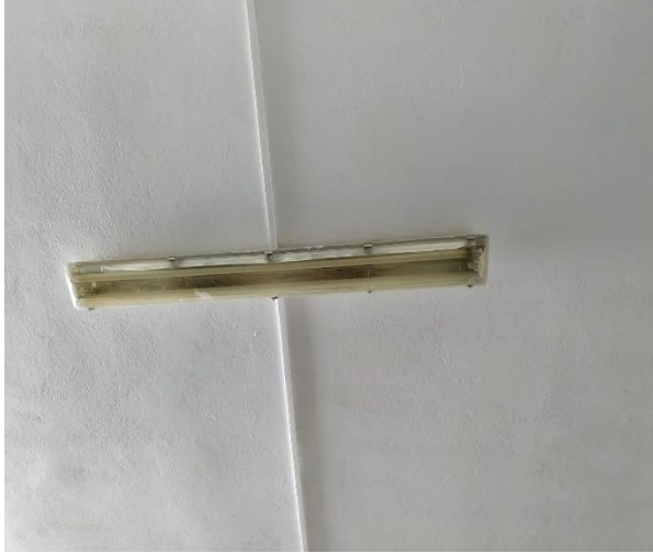
Εικόνα 3.8 Όψη των φωτιστικών
