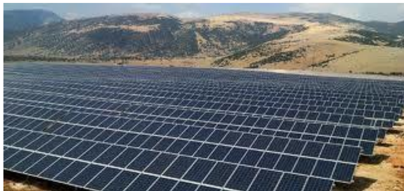
Εικόνα 6.3 Όψη φωτοβολταϊκής συστοιχίας
