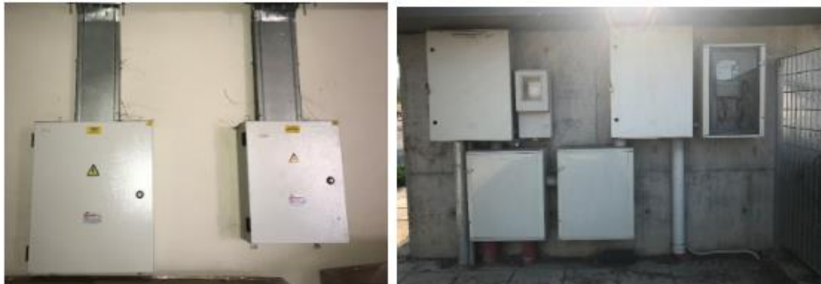
ΕΙΚΟΝΑ 4.6 ΠΙΝΑΚΕΣ ΕΛΕΓΧΟΥ ΕΣΩΤΕΡΙΚΑ ΚΑΙ ΕΞΩΤΕΡΙΚΑ ΤΟΥ ΚΤΙΡΙΟΥ
