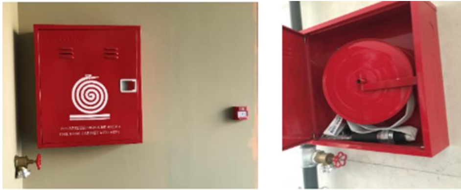
ΕΙΚΟΝΑ 1.4 ΠΥΡΟΣΒΕΣΤΙΚΗ ΦΩΛΙΑ (ΔΕΥΑ ΛΑΜΙΑΣ)
