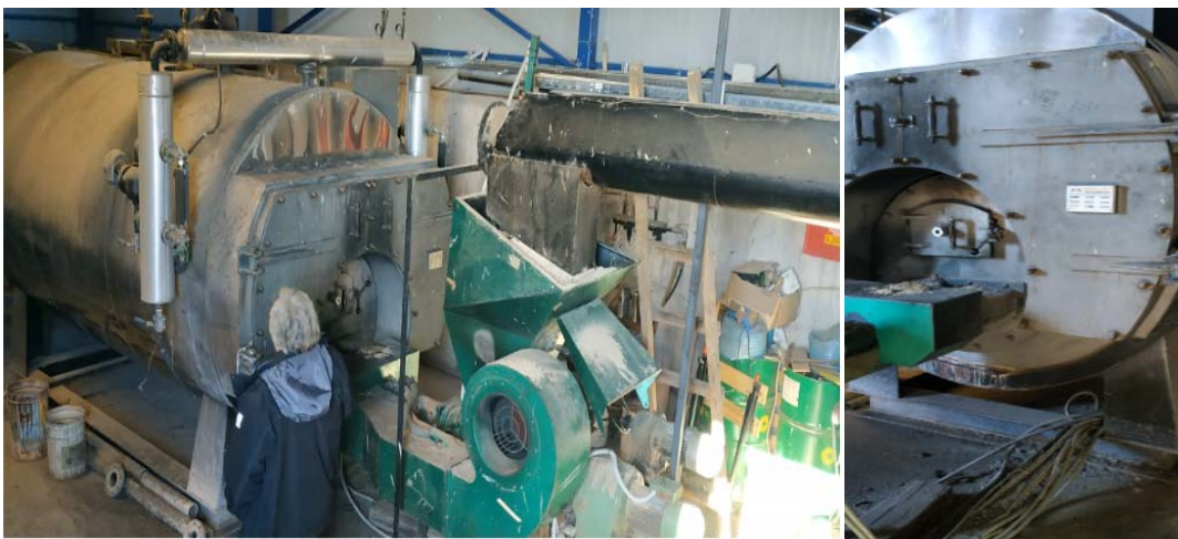
Εικόνα 2.19 : Λέβητας παραγωγής ατμού βιομηχανίας
