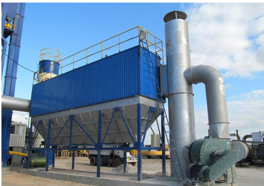
Εικόνα 2.7: Χώρος αποθήκευσης σκόνης (baghouse dust collector)
