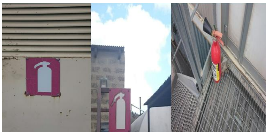
Εικόνα 5.5: Εγκατάσταση καταπολέμησης πυρκαγιάς
