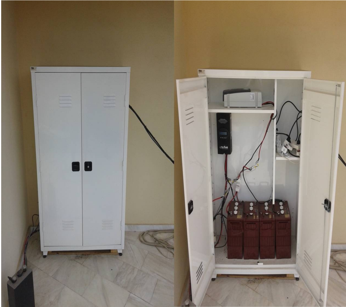
Σχήμα 3.17: Κιβώτιο προστασίας του εξοπλισμού.
