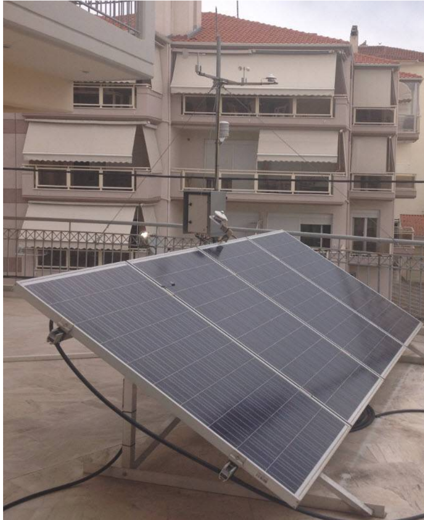
Σχήμα 3.1: Μετεωρολογικός Σταθμός και Αυτόνομο Φωτοβολταϊκό Σύστημα
