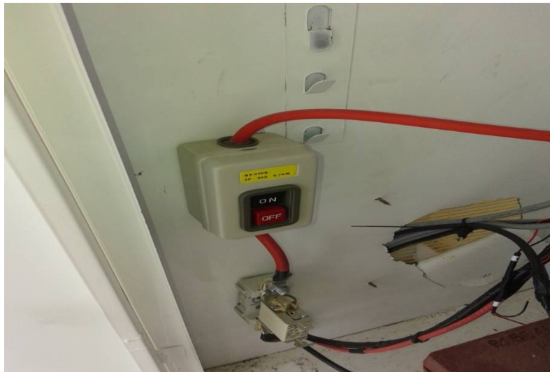
Σχήμα 3.13: Κύριος ηλεκτρικός διακόπτης (switch).
