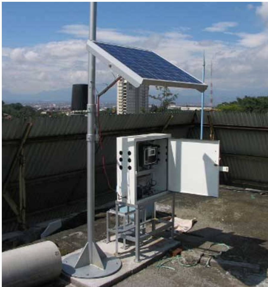
Σχήμα 4.3: Εγκατάσταση Data Logger σε εξωτερικό πειραματικό χώρο δοκιμών.
