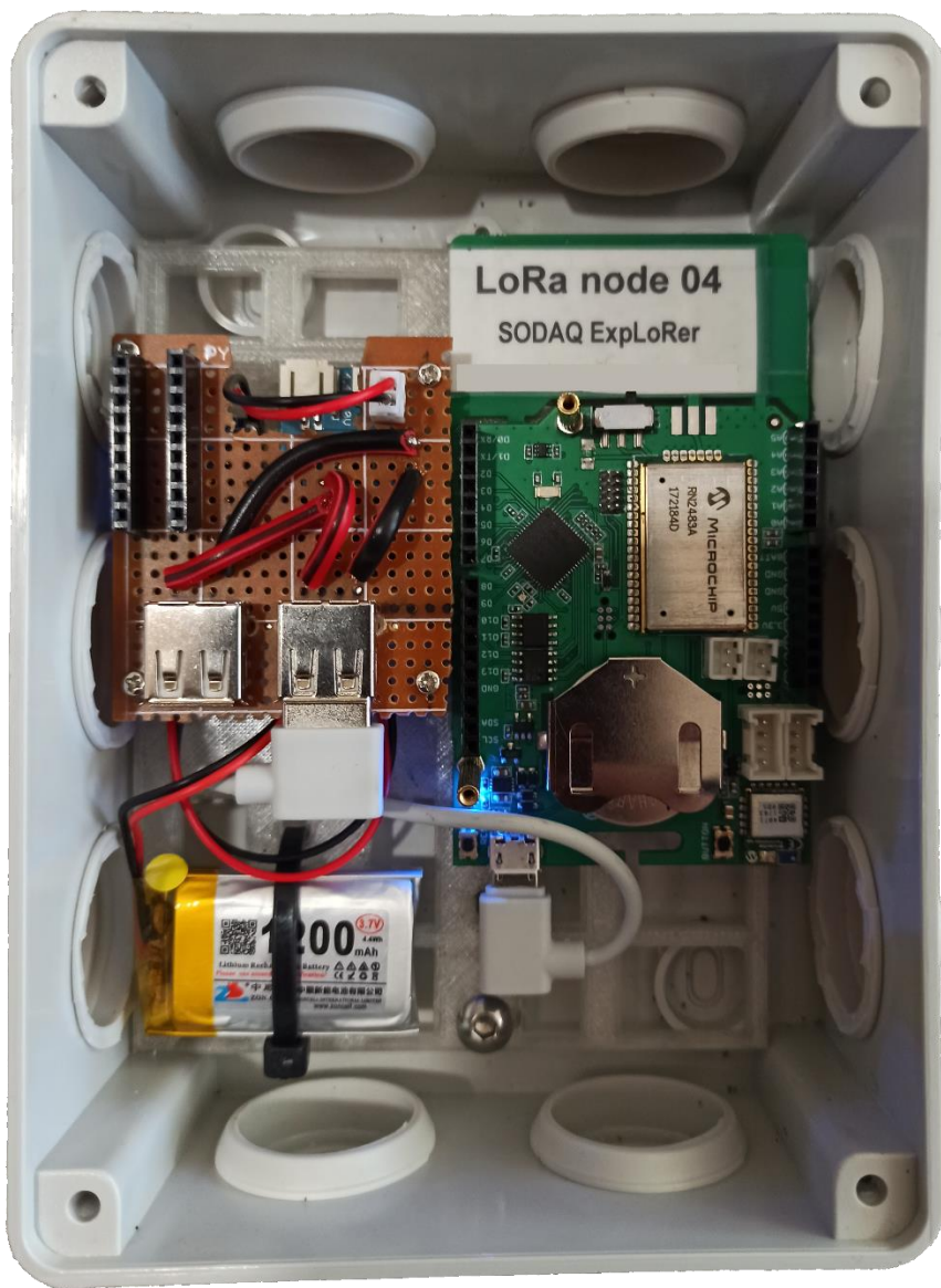
Εικόνα 30: Τοποθέτηση Sodaya ExpLoRer και κυκλώματος ηλιακής φόρτισης
