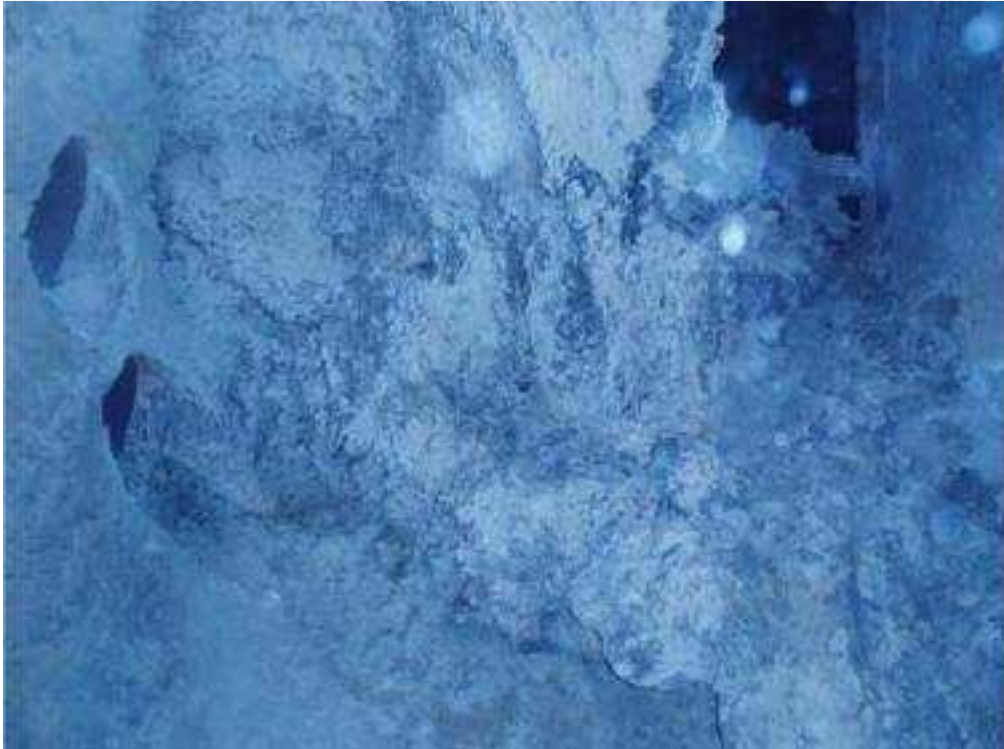
Εικόνα 11-72 : Επικαθίσεις στους Αγωγούς Ανακυκλοφορίας του Μύλου Μ44
