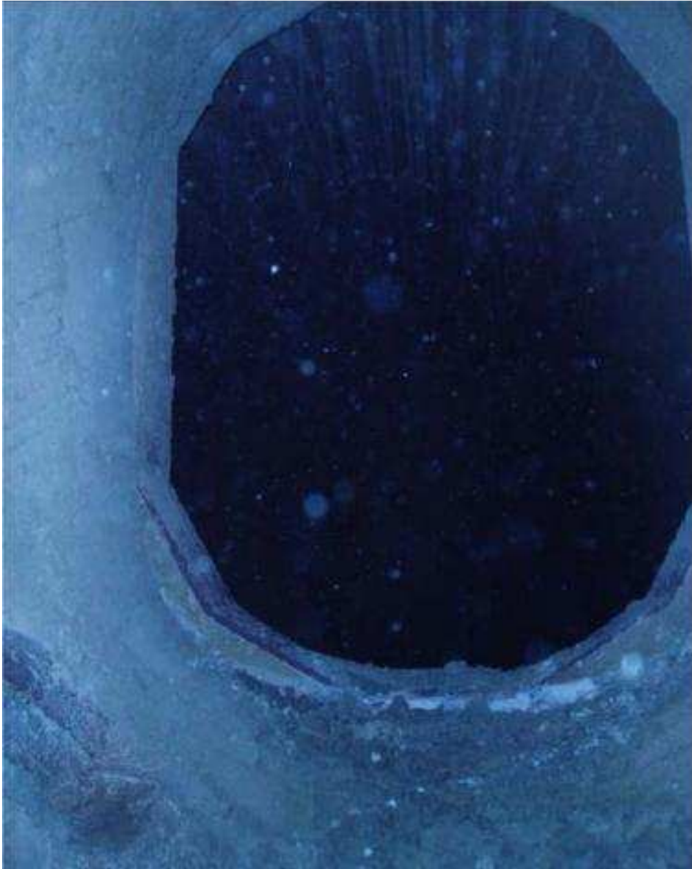
Εικόνα 11-77 : Επικαθίσεις στο Μέσο των Αγωγών Ανακυκλοφορίας του Μύλου M43
