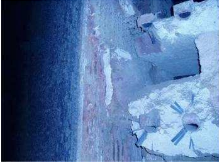
Εικόνα 11-82 : Κατεστραμμένο τμήμα κάτω κύριου καυστήρα 5 (Ύψος 20m)
