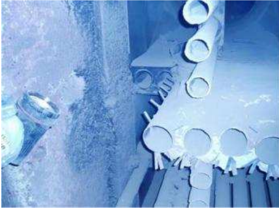
Εικόνα 11-84 : Κατεστραμμένο τμήμα κάτω κύριου καυστήρα 5 (Ύψος 20m)
