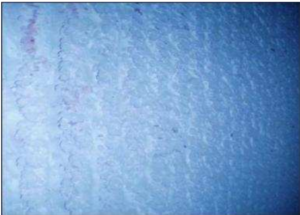
Εικόνα 11-10 : Επικαθίσεις στον εμπρόσθιο υδρότοιχο μεταξύ των καυστήρων
