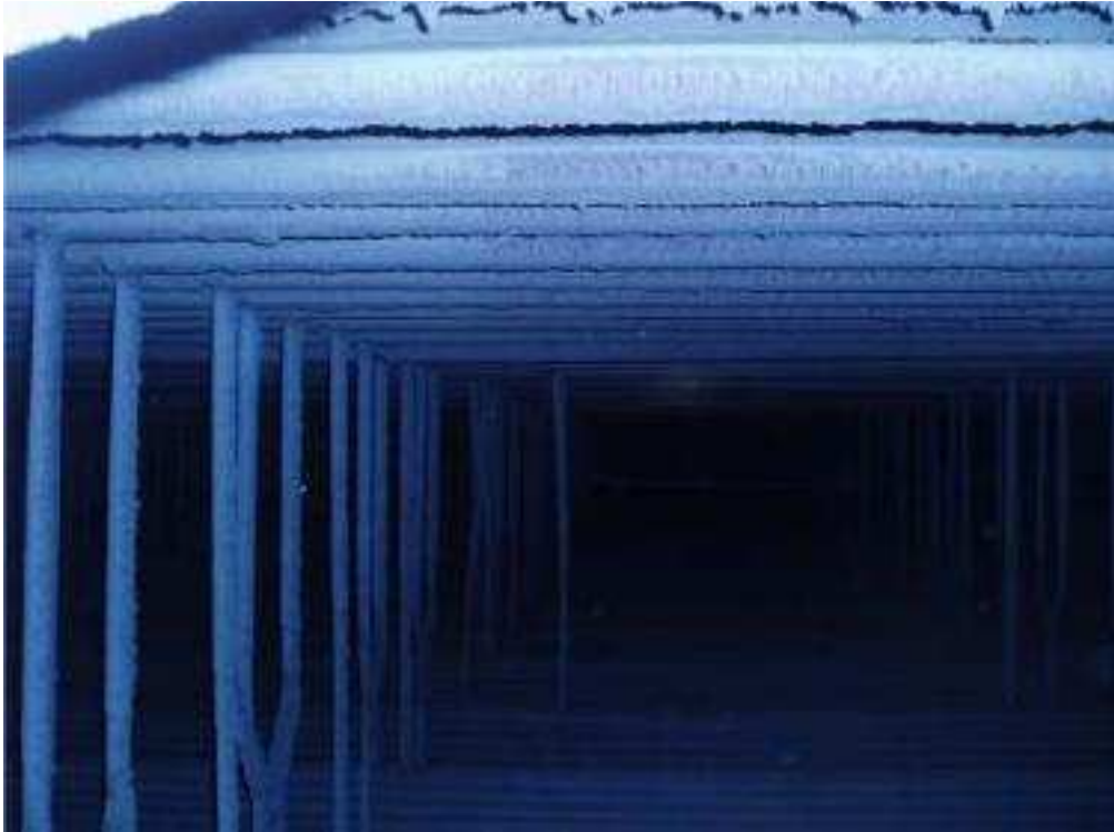
Εικόνα 11-62 : Παραμορφωμένοι σωλήνες στήριξης μεταξύ SH3 (Πάνω) και SH2 (Κάτω) (Ύψος 47,045 m)
