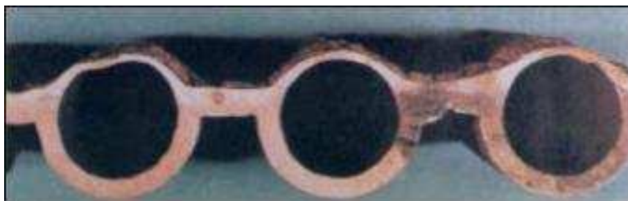
Εικόνα 9-5 : Χημική διάβρωση υδροτοιχωμάτων
