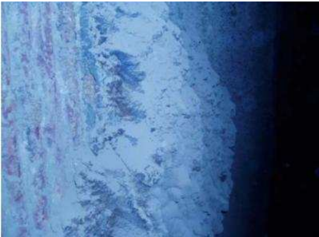
Εικόνα 11-79 : Ογκώδης επικαθιση στον εμπρόσθιο υδρότοιχο (Ύψος 25m)
