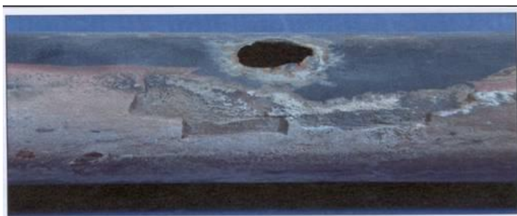
Εικόνα 1 - Διαβρωμένο τμήμα με διαρροή – εξωτερική επιφάνεια
