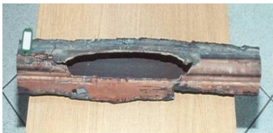
Εικόνα 11 - διαβρωμένο τμήμα αυλού από το αυλοτοιχώμα στα +34 m
