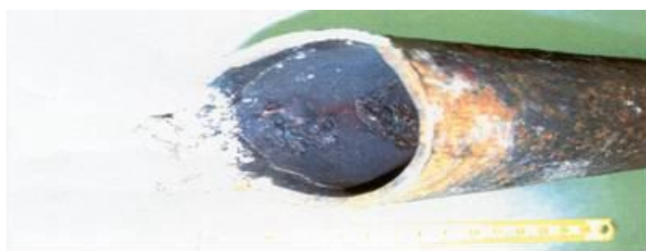
Εικόνα 21 – Αυλός εστίας/επικλινές τμήμα (+7 m) - διάβρωση υπό φόρτιση
