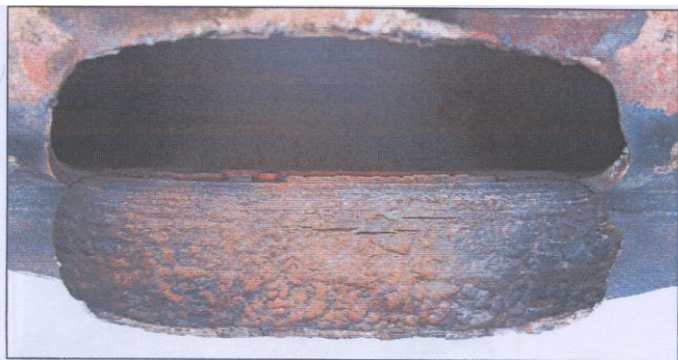
Εικόνα 16: Διαβρωμένο τμήμα αυλού από το αυλοτοιχώμα του λέβητα στην περιοχή ύψους +34m (θερμή πλευρά)
