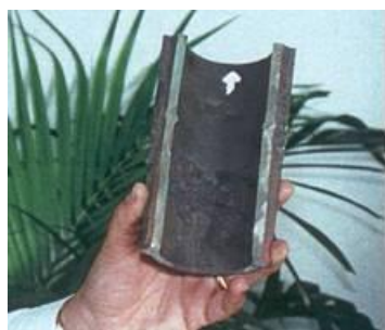
Εικόνα 13 – τμήμα σε συνέχεια του διαβρωμένου τμήματος αυλοτοιχώματος στα +34 m
