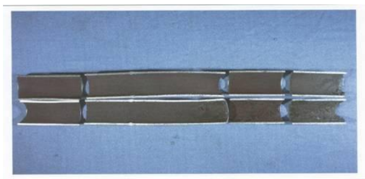
Εικόνα 6 - Διαβρωμένο τμήμα με διαρροή – εσωτερική επιφάνεια
