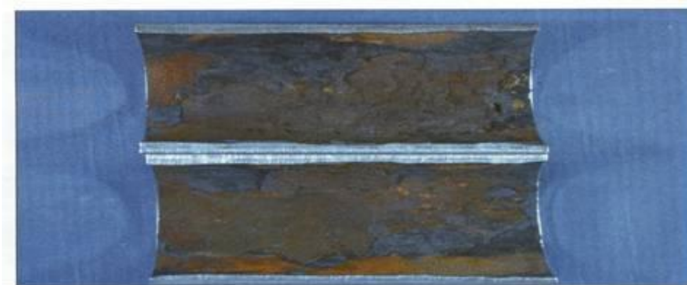
Εικόνα 2 - Διαβρωμένο τμήμα με διαρροή – εσωτερική επιφάνεια
