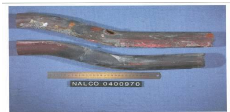
Εικόνα 5 - Διαβρωμένο τμήμα με διαρροή – εξωτερική επιφάνεια
