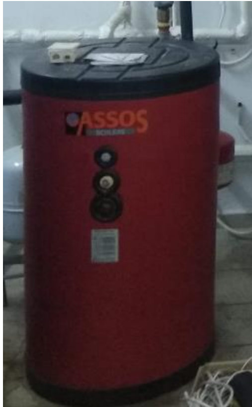
Εικόνα 4.3 Δεξαμενή αποθήκευσης ζεστού νερού προς κατανάλωση χρηστών.
