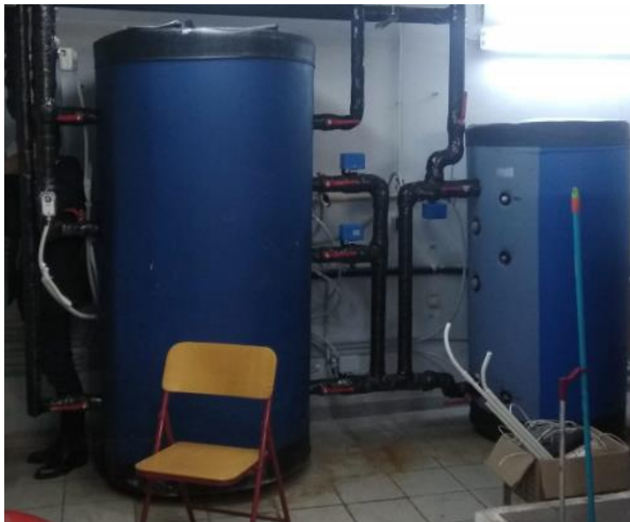
Εικόνα 4.6 Δεξαμενές αποθήκευσης ζεστού νερού προς θέρμανση κτιρίου.
