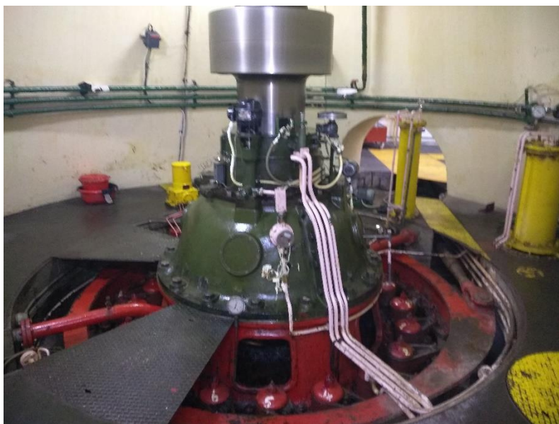
Σχήμα 13: Μία εκ των τουρμπινών της εγκατάστασης
