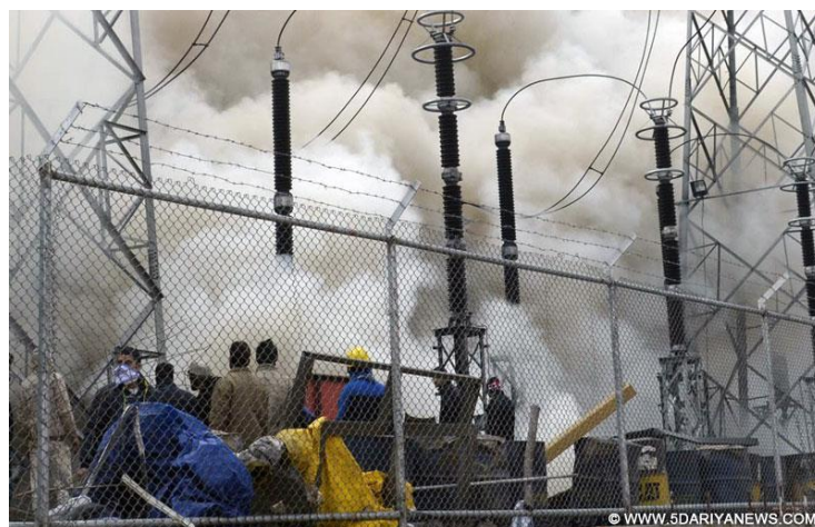
Σχήμα 10: Πυρκαγιά σε υποσταθμό στον ΥΗΣ Uri II (Ινδία)
