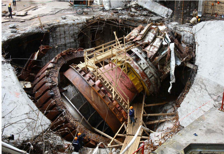
Σχήμα 8: καταστροφή τουρμπίνας στον ΥΗΣ Sayano Shushenskaya (Ρωσία)
