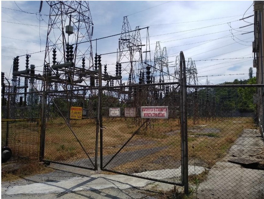
Σχήμα 16: Υποσταθμός 150KVolt και γραμμές μεταφοράς
