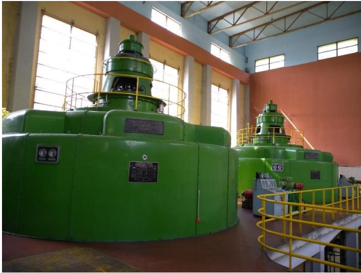
Σχήμα 14: Εξωτερική φωτογραφία των γεννητριες εγκατάστασης
