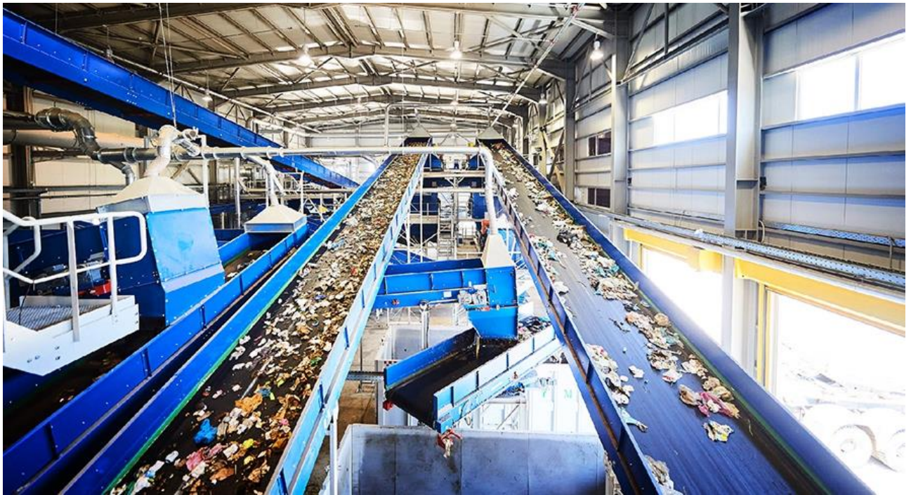
Εικόνα 17: Εγκατάσταση Μηχανικής Διαλογής (Πηγή: www.ypodomes.com Τελευταία πρόσβαση στις 22-06-2020)
