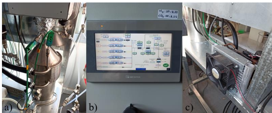
Εικόνα 3.3: α) Ο εναλλάκτης θερμότητας. β) Το πάνελ της μονάδας όπου ρυθμίζονται οι θερμοκρασίες και οι ροές εισόδου και γ) Το σύστημα ψύξης της μονάδας.
