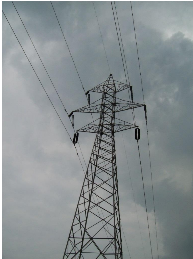
Εικόνα 3.2: ΓΜ 150 kV του ΕΣΜΗΕ με έναν αγωγό προστασίας με τη μεσαία φάση να προεξέχει έναντι των άλλων δύο. Η κάθε αλυσίδα μονωτήρων αποτελείται από 10-12 δισκοειδείς μονωτήρες.
