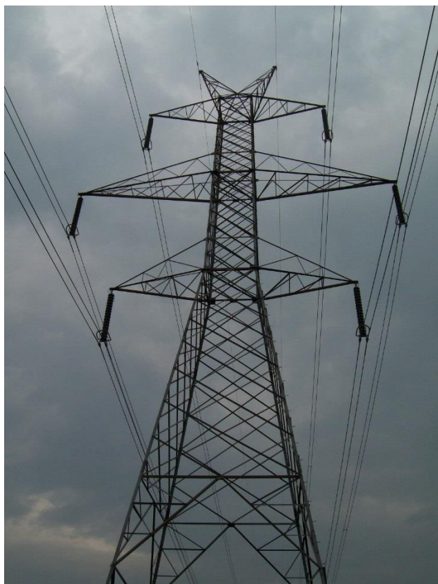
Εικόνα 3.3: ΓΜ 400 kV του ΕΣΜΗΕ με δύο αγωγούς προστασίας με τη μεσαία φάση προεξέχει έναντι των άλλων δύο. Στο κάτω μέρος των μονωτήρων υπάρχει ένας αγωγός δακτύλιος γύρω από τον τελευταίο δισκοειδή μονωτήρα (για την εξομάλυνση της κατανομής τάσης). Η κάθε αλυσίδα μονωτήρων αποτελείται από 17-19 δισκοειδείς μονωτήρες.
