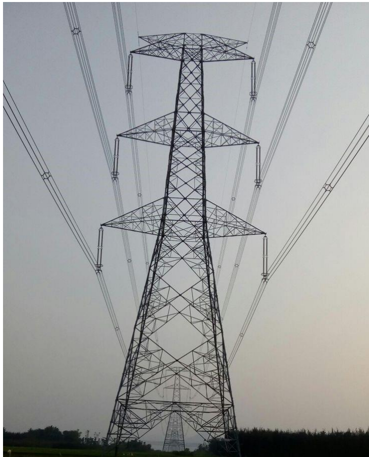
Εικόνα 3.4: ΓΜ 765 kV με δύο αγωγούς προστασίας. Είναι αδύνατον να πληγεί κάποιος αγωγός φάσης από κεραυνό, παρά μόνο οι αγωγοί προστασίας βάσει ηλεκτρογεωμετρικών μοντέλων σύλληψης του κεραυνού καθώς η γωνία θωράκισης είναι αρνητική [7].
