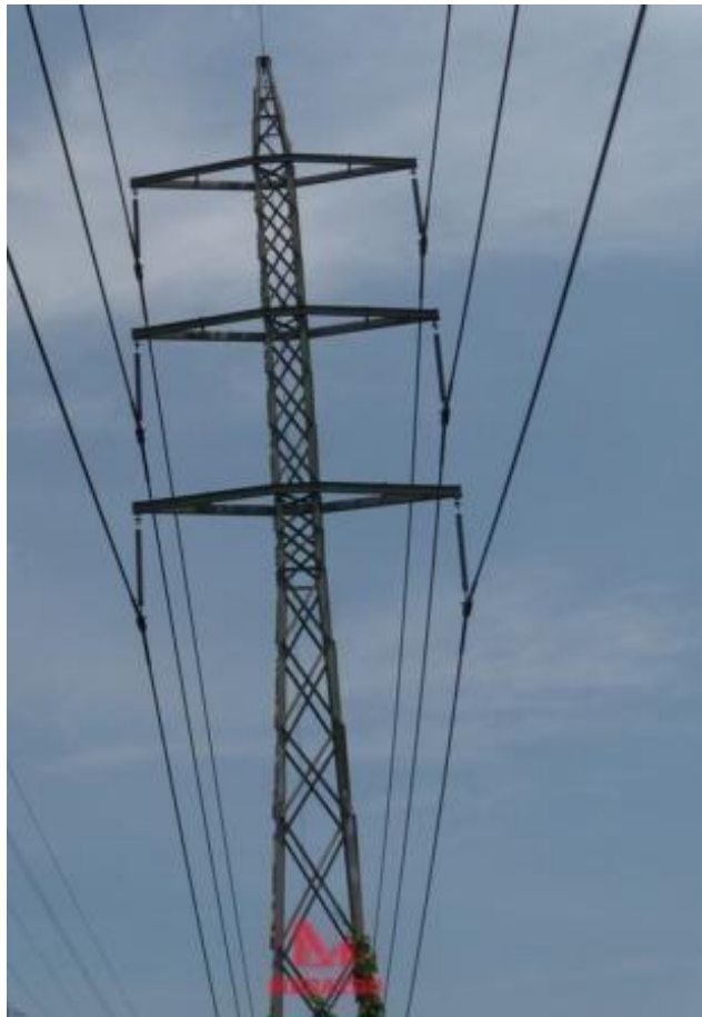
Εικόνα 3.1: ΓΜ 66 kV στην Κίνα με έναν αγωγό προστασίας και 3 φάσεις εκατέρωθεν του πυλώνα [6].
