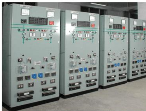
Σχήμα 15: Μηχανισμός ρελέ σε έναν υποσταθμό [14].
