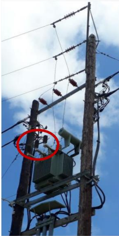
Σχήμα 22: Εκτροπείς υπέρτασης σε υποσταθμό διανομής ηλεκτρικής ενέργειας.
