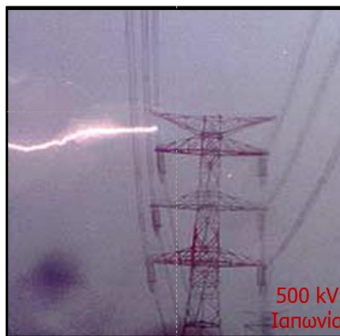
Σχήμα 28: Πλήγμα σε αγωγό φάσης σε εναέρια γραμμή 500 kV στην Ιαπωνία [33].
