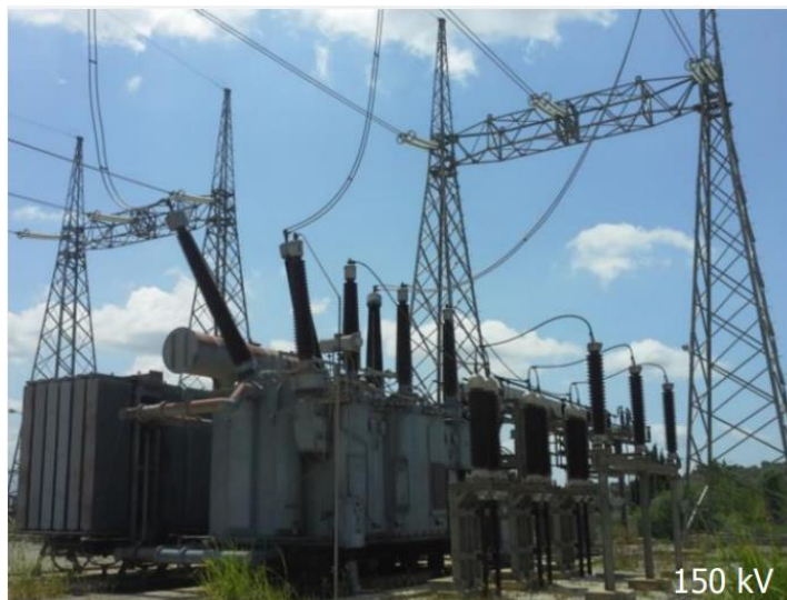
Σχήμα 21: Εκτροπείς υπέρτασης σε υποσταθμό συστήματος μεταφοράς ηλεκτρικής ενέργειας.
