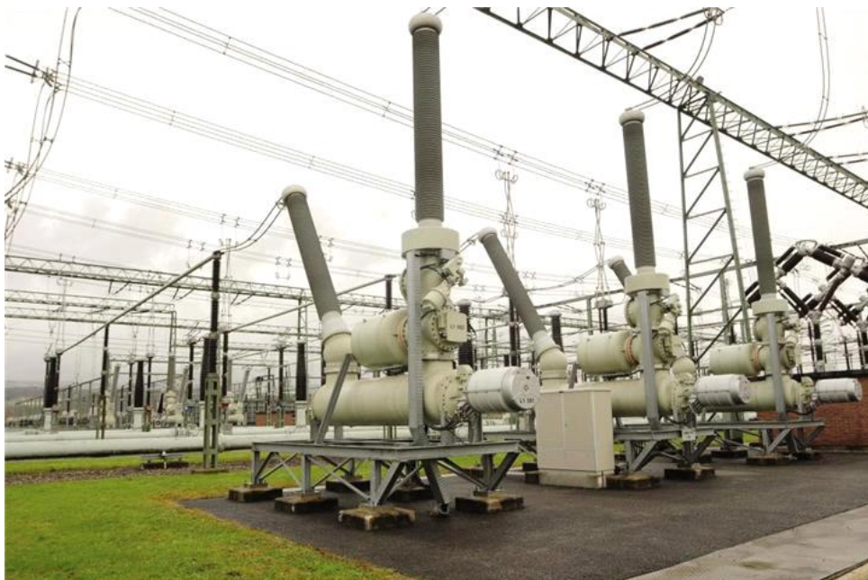
Σχήμα 1: Τυπικός υποσταθμός υψηλής τάσης [1].
