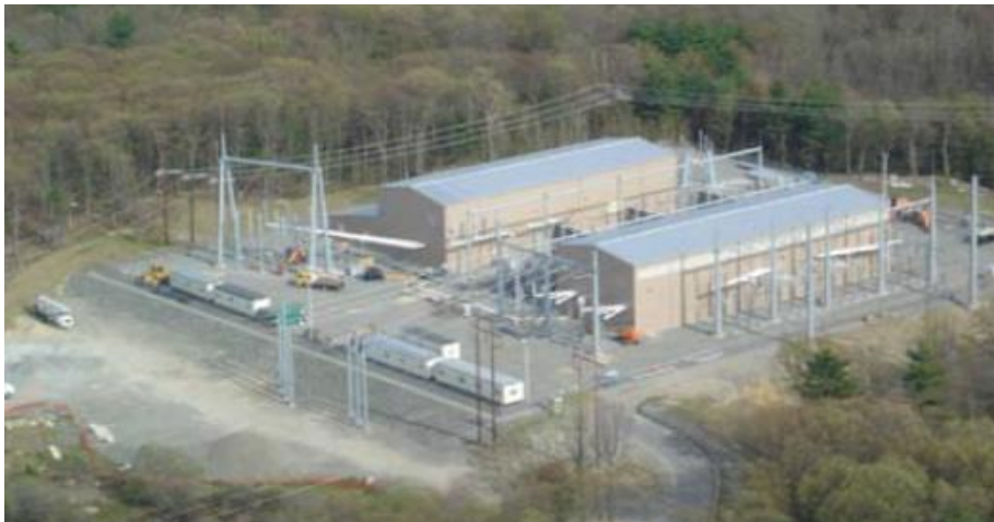
Σχήμα 7: Υποσταθμός GIS εσωτερικού χώρου [7].
