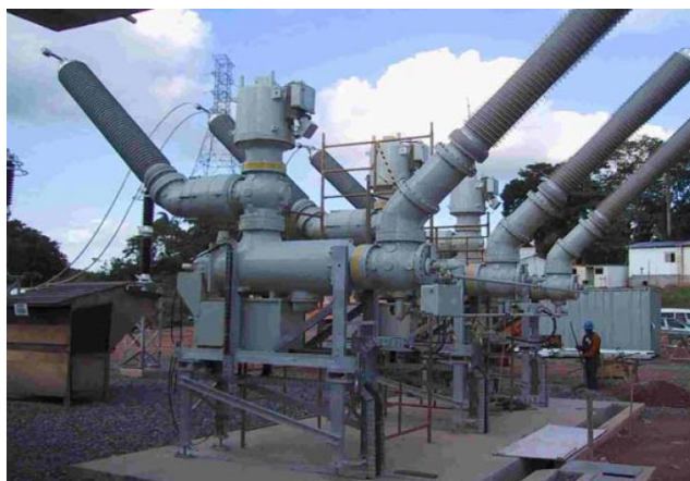
Σχήμα 8: Υποσταθμός MTS εξωτερικού χώρου, 230 kV [8].
