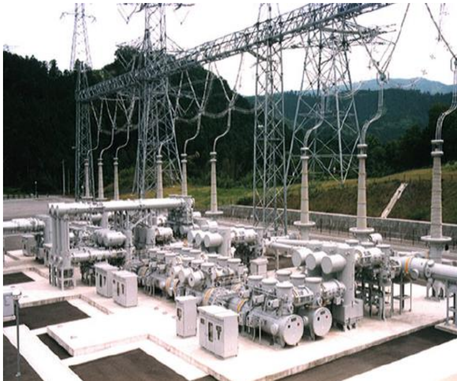
Σχήμα 4: Υποσταθμός GIS σε εξωτερικό χώρο [4].
