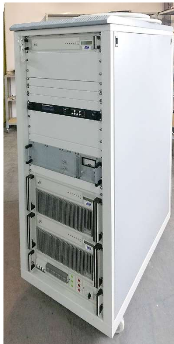
Εικόνα 2.2 Διαρρύθμιση μηχανημάτων σε σταθμό αναμετάδοσης τηλεοπτικού σήματος
