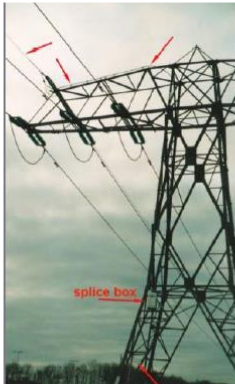
Εικόνα 1 - Σημείο τοποθέτησης καλωδίου οπτικής ίνας OPGW σε πυλώνα υπερυψηλής τάσης (Παναγογιαννόπουλος, 2008)
