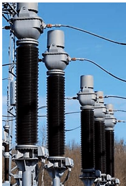
Εικόνα 1.5 Μετασχηματιστής οργάνων που συνδυάζει μετασχηματιστή τάσης και έντασης σε υποσταθμό AIS υψηλής τάσης [4].
