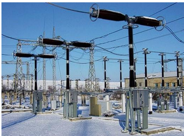
Εικόνα 1.2 Διακόπτες ισχύος τύπου περιβλήματος υπό τάση σε υποσταθμό AIS υψηλής τάσης [2].
