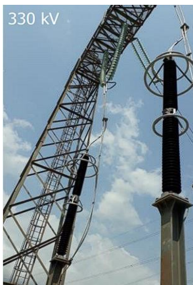
Εικόνα 1.4 Εκτροπείς υπέρτασης σε υποσταθμό AIS υψηλής τάσης 330 kV [3].
