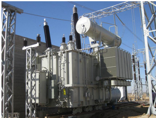
Εικόνα 1.1 Μετασχηματιστής ισχύος σε υποσταθμό υψηλής τάσης [1].
