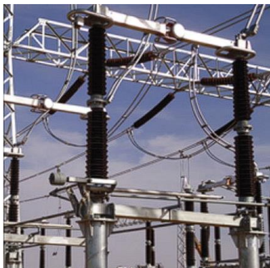
Εικόνα 1.3 Τυπικός αποζεύκτης σε υποσταθμό AIS υψηλής τάσης [2].
