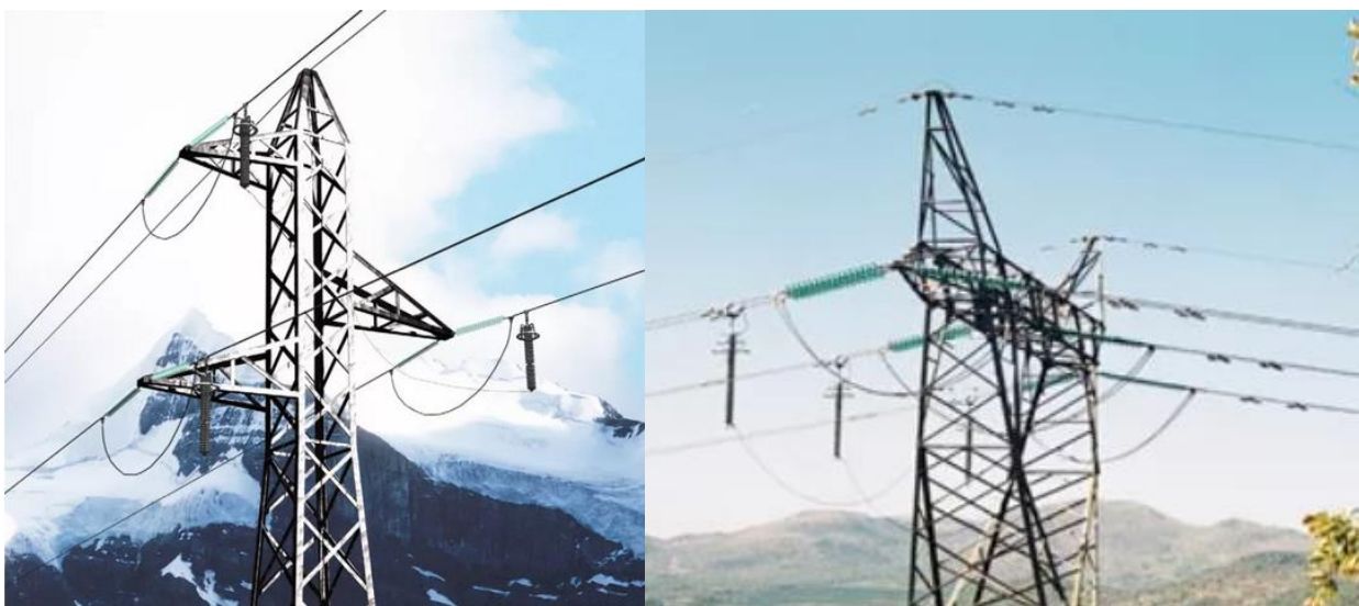
Εικόνα 5. Πιθανός τρόπος σύνδεσης του εκτροπέα μεταξύ πυλώνα και φάσης για την προστασία μονωτήρων αποτρέποντας την ηλεκτρική διάσπαση μεταξύ φάσης και πυλώνα [8].
