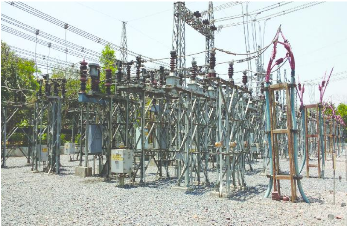
Εικόνα 1. Υποσταθμός με μόνωση αέρα (AIS, Air Insulated Substation/Switchgear) [5].
