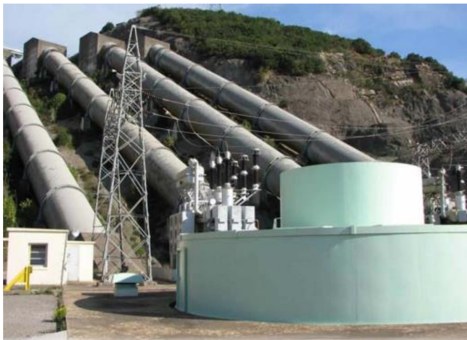
Εικόνα 15 Εξωτερικοί αγωγοί προσαγωγής
