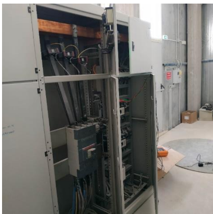
Εικόνα 10: Ερμάριο κεντρικού διακόπτη Ισχύος της δεξιάς συστοιχίας
