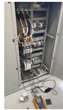
Εικόνα 12: Ερμάριο που τροφοδοτεί το AC Drive. 2 η Φάση Μετρήσεων
