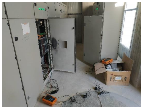
Εικόνα 13: Χώρος Ηλεκτρικής εγκατάστασης Λατομείου κατά την διάρκεια των μετρήσεων.
