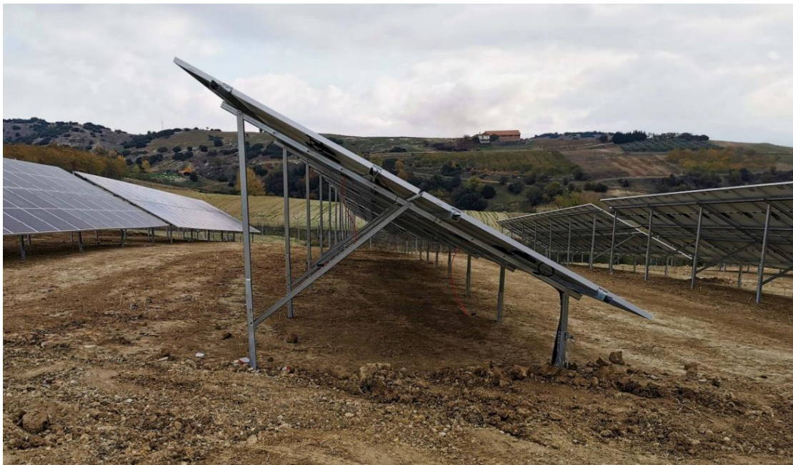
Εικόνα 1. ΦΒ πάνελ σταθερής κλίσης [11].
