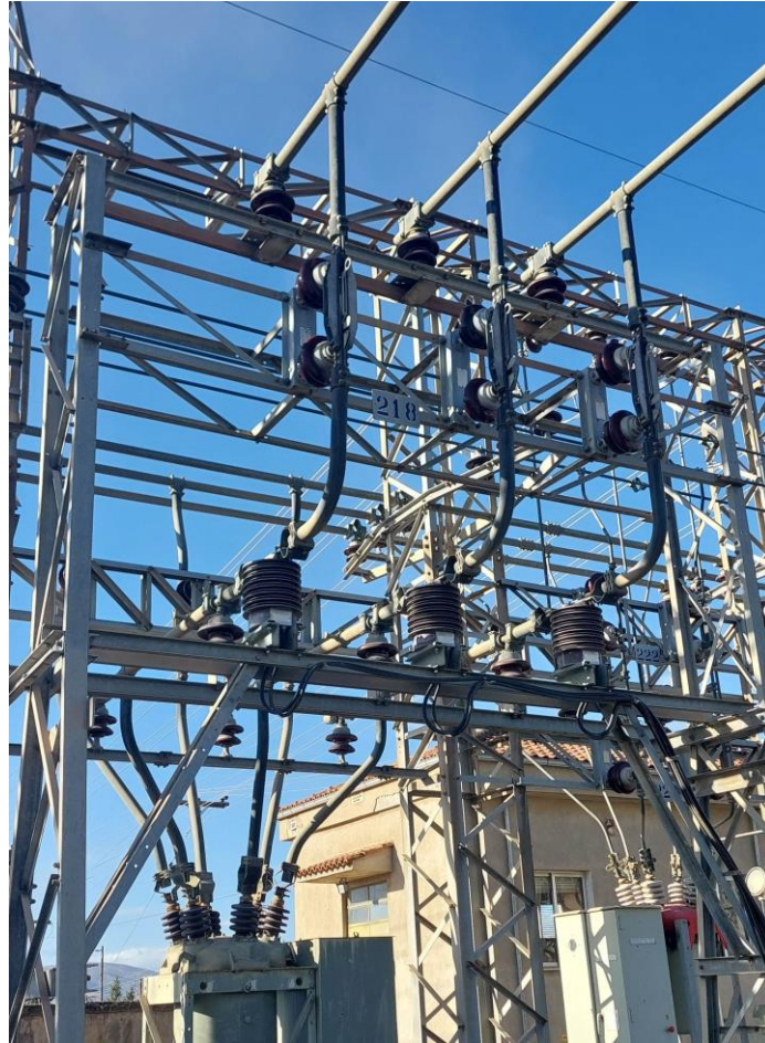
Εικόνα 14: Αποζεύκτης μέσης τάσης
