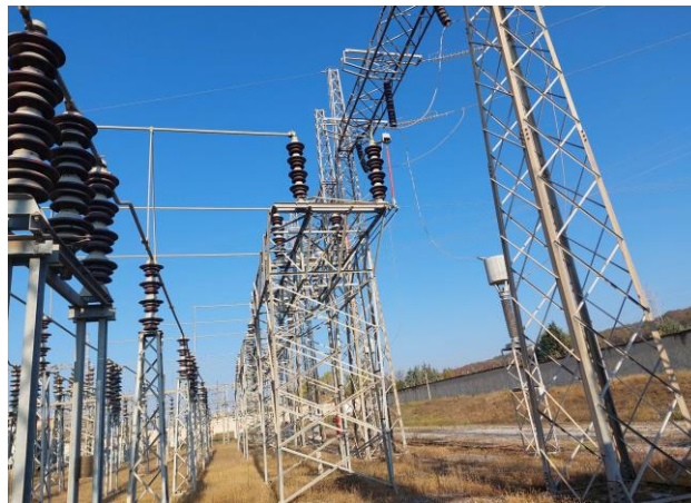
Εικόνα 13: Αποζεύκτης υψηλής τάσης
