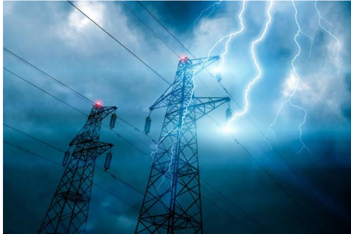
Εικόνα 17: Κεραυνικό πλήγμα πάνω σε φάση πυλώνα [12]
