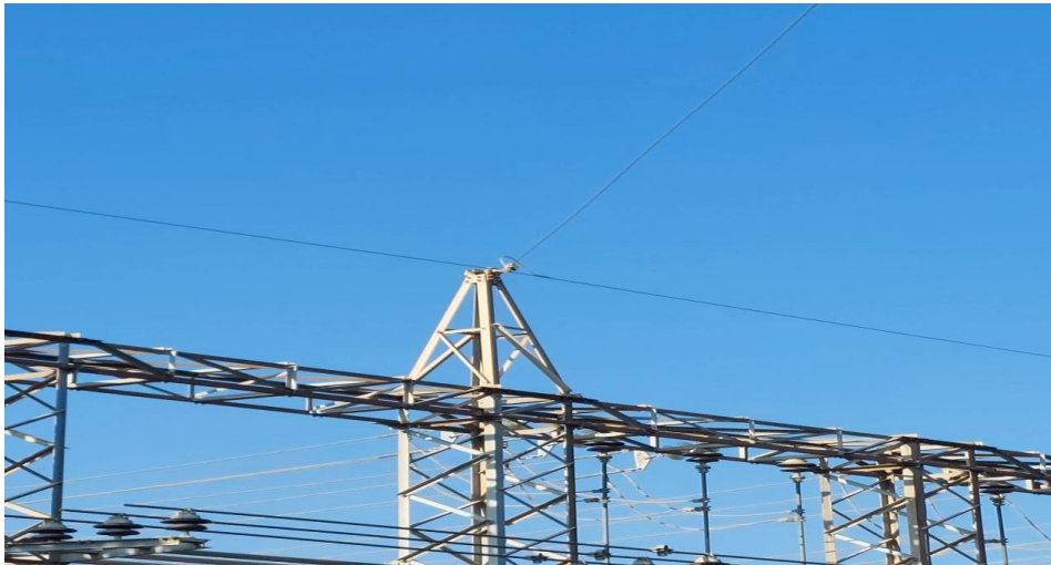
Εικόνα 16: Αγωγοί γης με τους οποίους προστατεύεται ο υποσταθμός από άμεσο κεραυνικό πλήγμα
