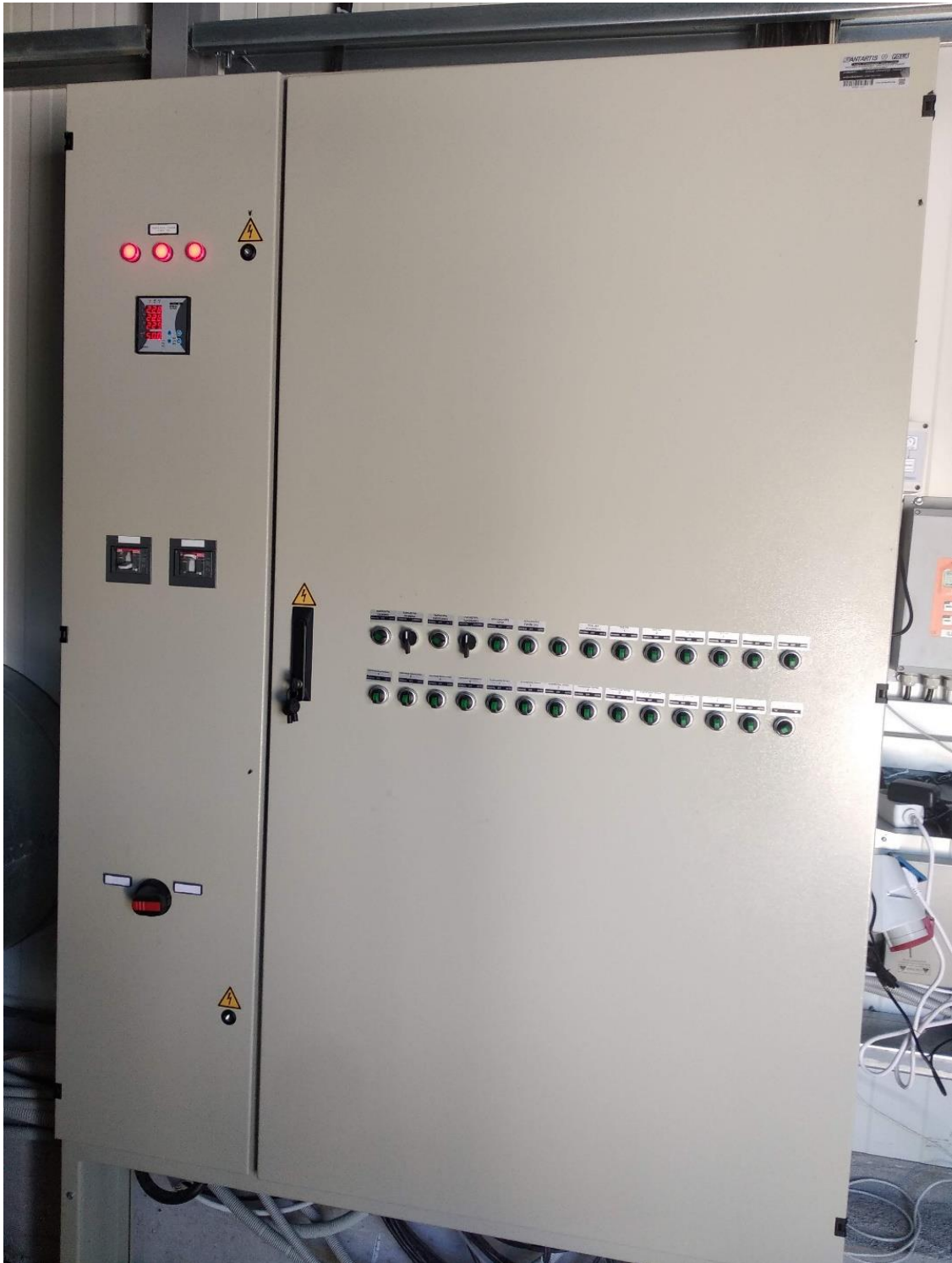
ΕΙΚ. 38: Ηλεκτρικός πίνακας
