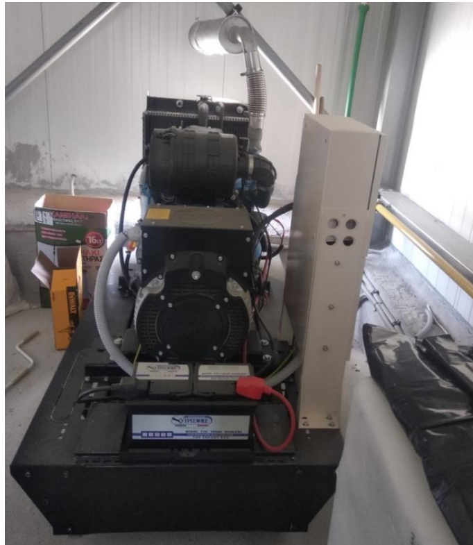
ΕΙΚ. 35: Γεννήτρια σε περίπτωση διακοπής ρεύματος
