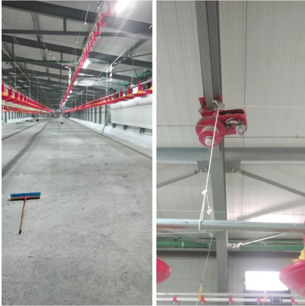
ΕΙΚ. 5: Ολοκλήρωση κτιρίου, βίντσι για το ανεβοκατέβασμα των ταϊστρών και των πιπίλων
