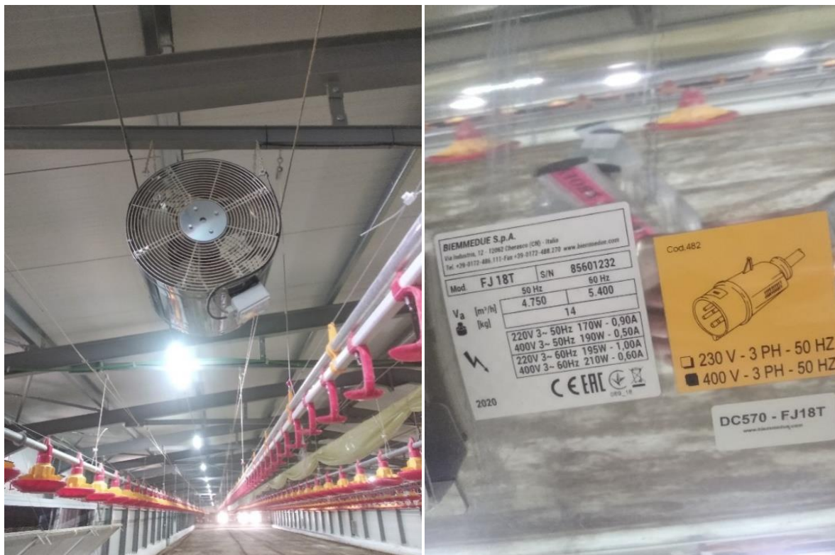
ΕΙΚ. 13: Ανεμιστήρες Ανακυκλοφορίας του αέρα για ομοιόμορφη κατανομή της θερμοκρασίας
