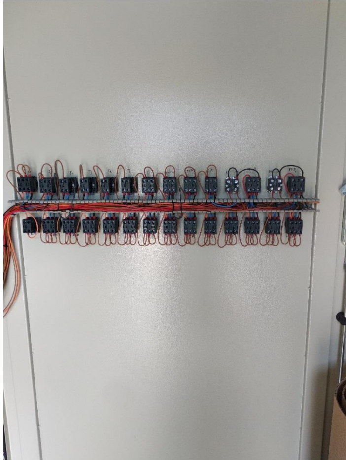
ΕΙΚ. 41: Πόρτα πίνακα εσωτερικά
