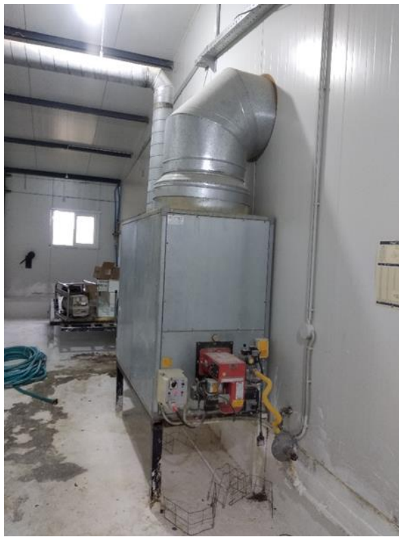
ΕΙΚ. 23: Λέβητας αερίου για την θέρμανση της μονάδας
