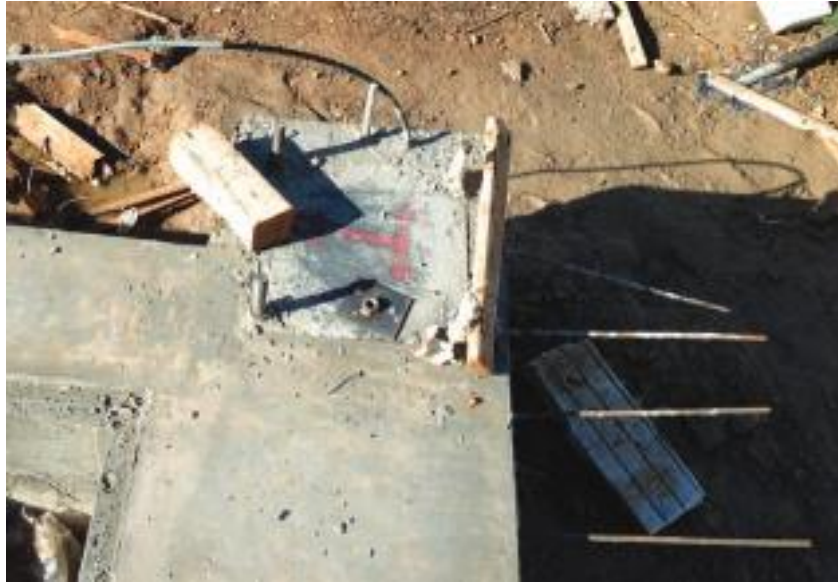
Εικόνα 25. Αναμονή για την σύνδεση με αγωγό καθόδου του συστήματος γείωσης αντί-κεραυνικής προστασίας από την θεμελιακή γείωση. Ο αγωγός έχει καλυφθεί με ταινία PCV για την αποφυγή διάβρωσης μετά την σκυροδέτηση (Πηγή: ΕΛΟΤ, 2010)
