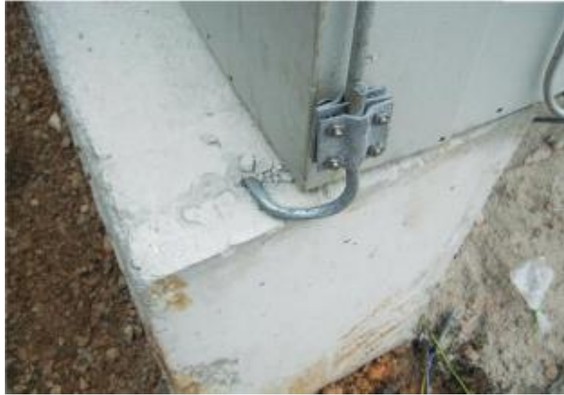
Εικόνα 23. Εσφαλμένη εγκατάσταση αγωγού St-Zn κατά την έξοδο από το σκυρόδεμα (Πηγή: ΕΛΟΤ, 2010)
