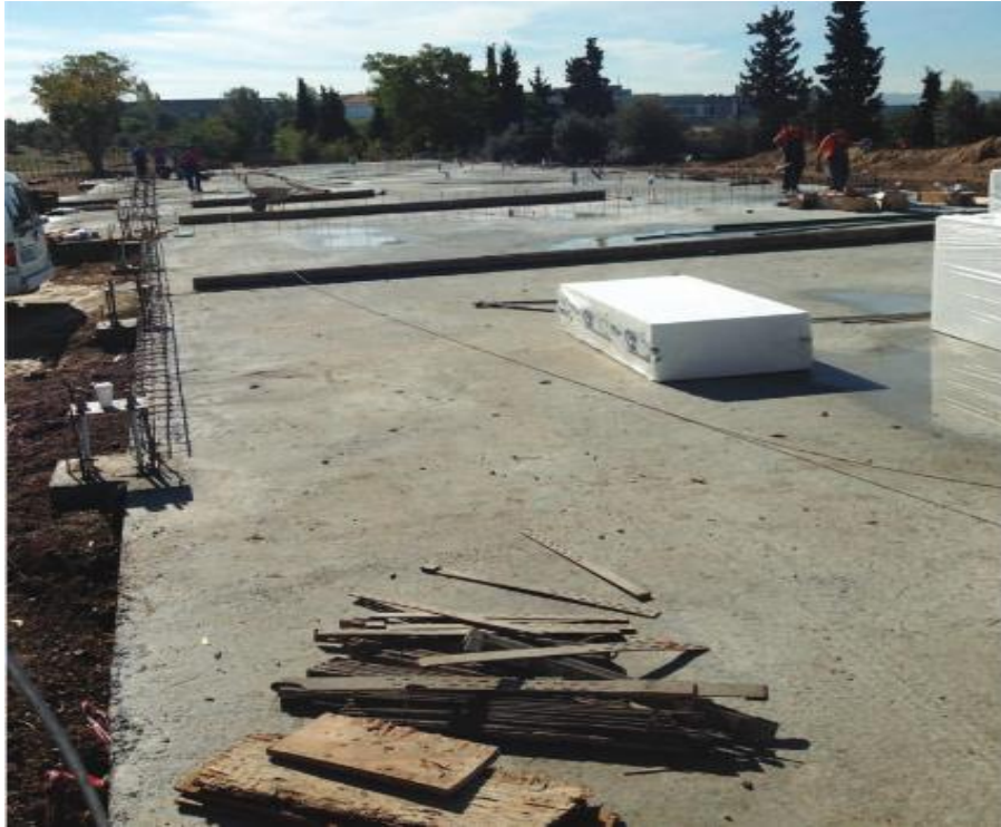
Εικόνα 20. Φωτογραφία εργοταξίου μετά την σκυροδετήση της πλάκας. Έχουν αφεθεί αναμονές για τις ισοδυναμικές συνδέσεις και τις συνδέσεις με το σύστημα γείωσης αντί-κεραυνικής προστασίας (Πηγή: ΕΛΟΤ, 2010)
