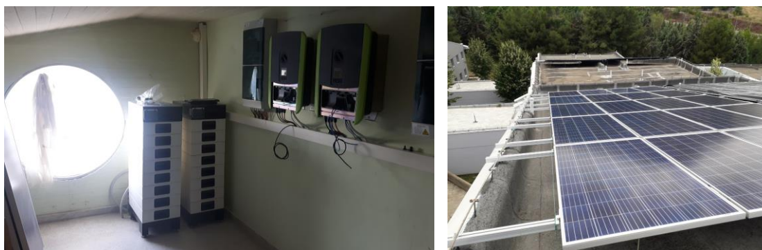
Figure 9 Φωτογραφίες εγκατάστασης (εσωτερική εγκατάσταση και φωτοβολταϊκά πάνελ στην οροφή)
