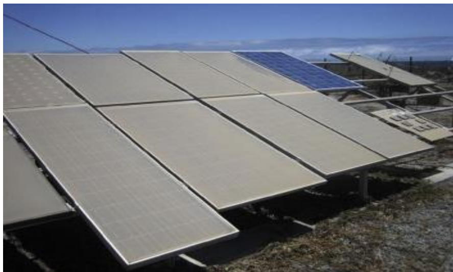
Εικόνα 27. Επικαθίσεις σκόνης σε φωτοβολταϊκά πάνελς (Πηγή: Schill et al 2015 32 )
