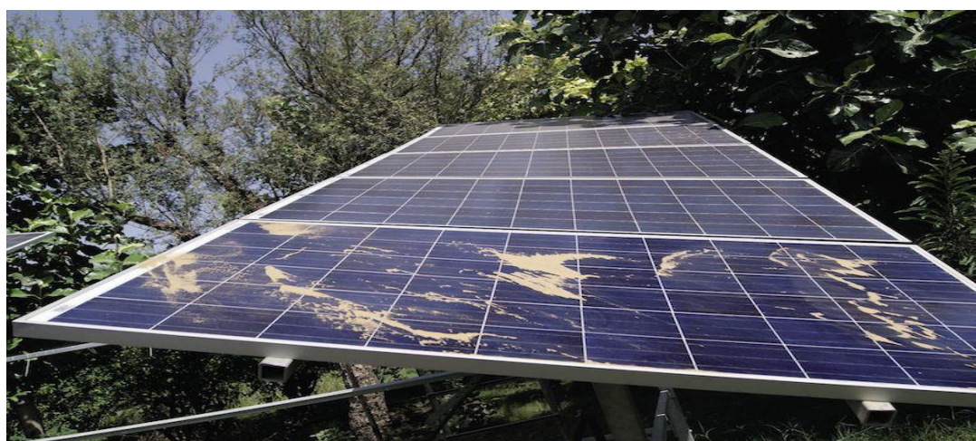
Εικόνα 28. Χωμάτινες επικαθίσεις και ανεπιθύμητη σκίαση λόγω βλάστησης σε φωτοβολταϊκό (Πηγή: Clover I., www.pv-magazine.com 2017 24 )
