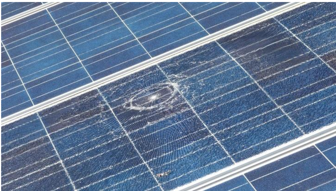
Εικόνα 32. Θραύση γυάλινου πλαισίου φωτοβολταϊκού λόγω χαλαζόπτωσης (Πηγή: www.pneurope.eu 35 )
