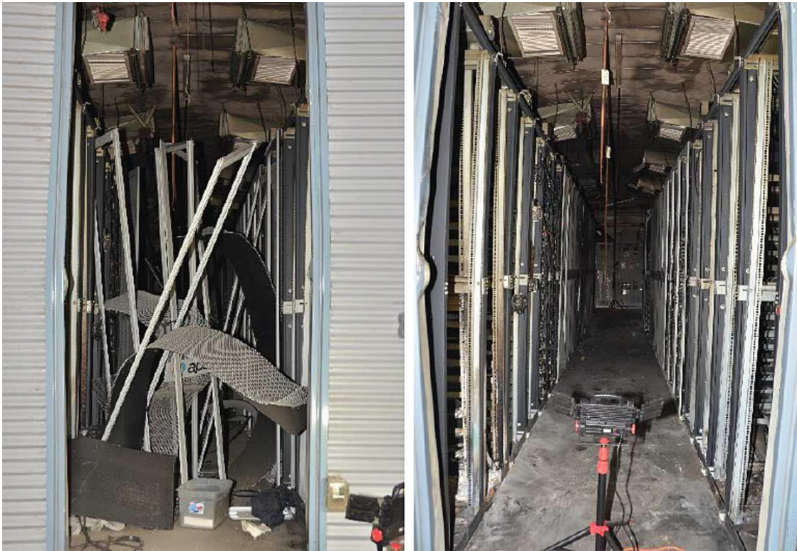
Εικόνα 40. Η ζημιά που προκλήθηκε στο εσωτερικό της μονάδας συσσωρευτών της Arizona Public Service (Πηγή: Wagman 2020 44 )
