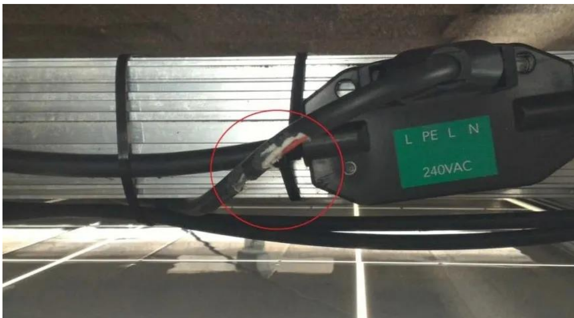
Εικόνα 36. Φθαρμένη μόνωση καλωδίωσης σε εγκατάσταση φωτοβολταϊκών από τρωκτικά (Πηγή: www.ontario-solar-installers.ca 38 )
