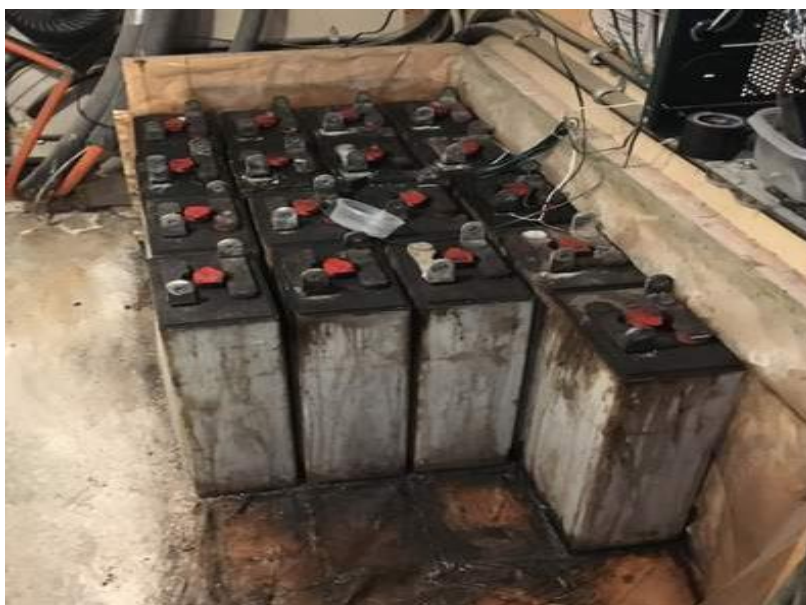
Εικόνα 49. Συσσωρευτές μονάδας φωτοβολταϊκών με έντονα σημάδια διάβρωσης (Πηγή: https://solarbuildermag.com )
