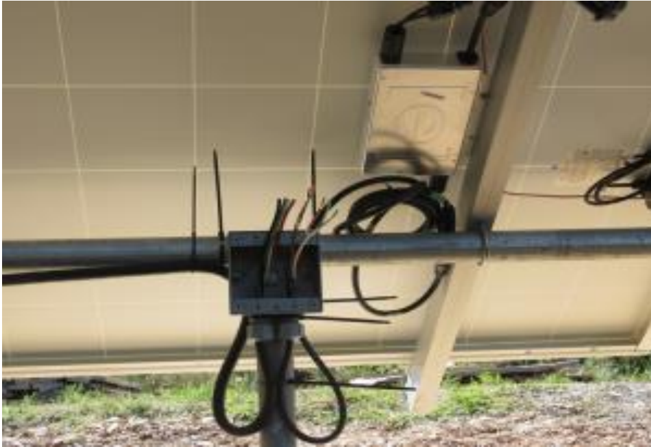
Εικόνα 13: Τμήμα του συστήματος καλωδιώσεων ενός φωτοβολταϊκού πλαισίου
