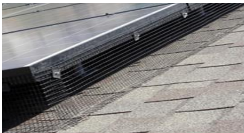
Εικόνα 48. Χρήση προστατευτικού μεταλλικού πλέγματος σε πάνελ φωτοβολταϊκών (Πηγή: www.ontario-solar-installers.ca 38 )
