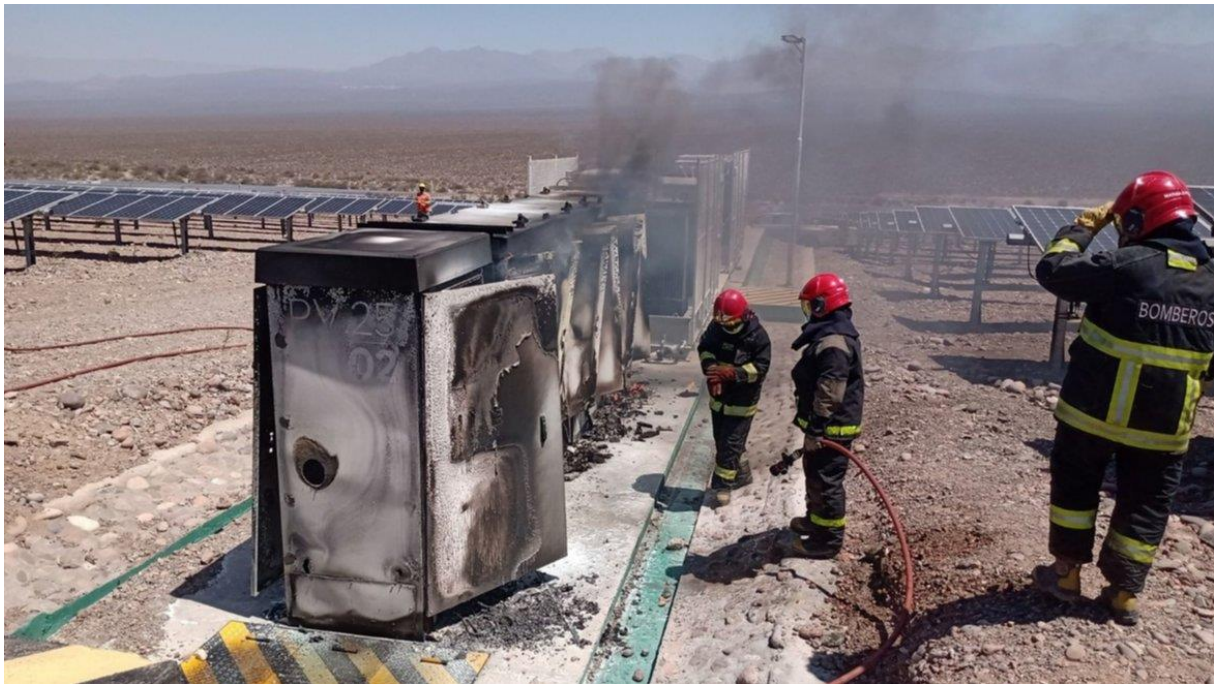
Εικόνα 35. Η πυρκαγιά στους inverters του φωτοβολταϊκού πάρκου στο Ullum της Αργεντινής (Πηγή: www.pv-magazine.com 36 )
