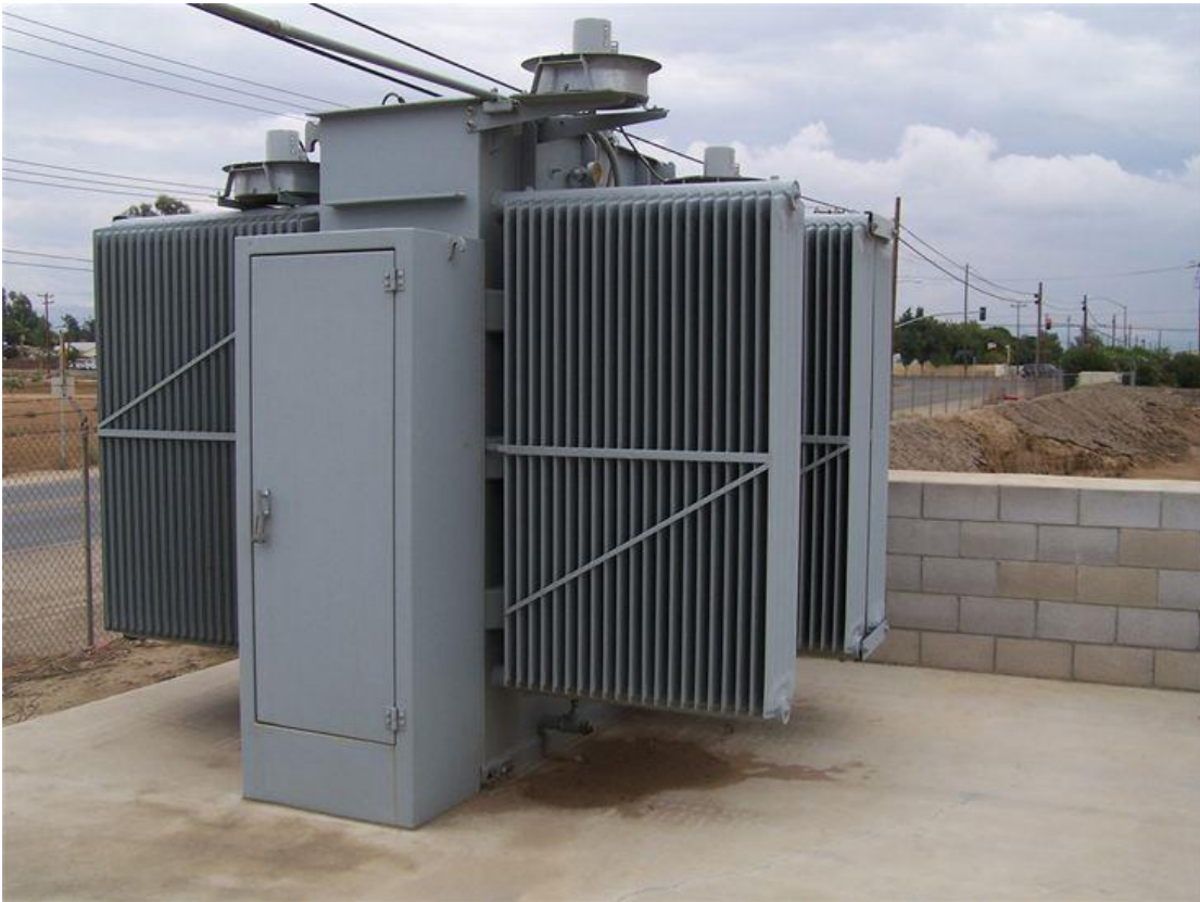
Εικόνα 39. Διαρροή λαδιού σε μετασχηματιστή (Πηγή: www.transformermaintenance.com 42)
