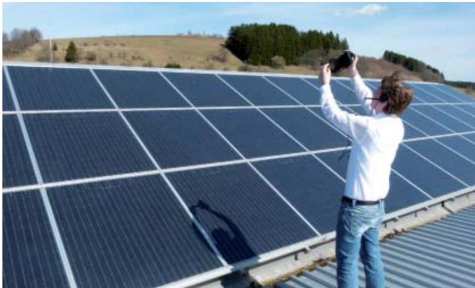
Εικόνα 50. Χρήση θερμοκάμερας για θερμογράφιση φωτοβολταϊκής εγκατάστασης (Πηγή: www.murcal.com )
