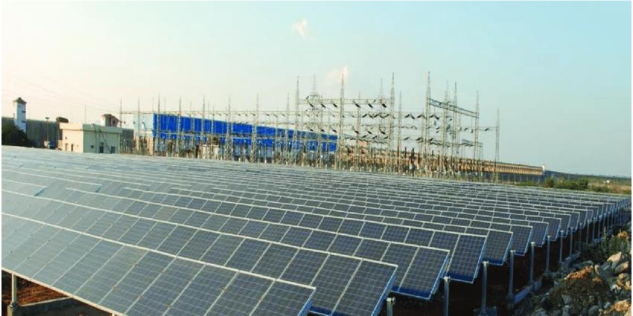
Εικόνα 24: Φωτοβολταϊκό πάρκο εγκατεστημένης ισχύος 1MWp με τον υποσταθμό μέσης τάσης στο βάθος (Πηγή: Malvoni et al 2020 23 )
