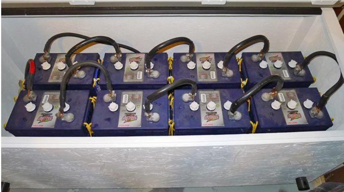
Εικόνα 16: Συστοιχία συσσωρευτών για την αποθήκευση ηλεκτρικής ενέργειας (Πηγή: www.4green.gr 43 )
