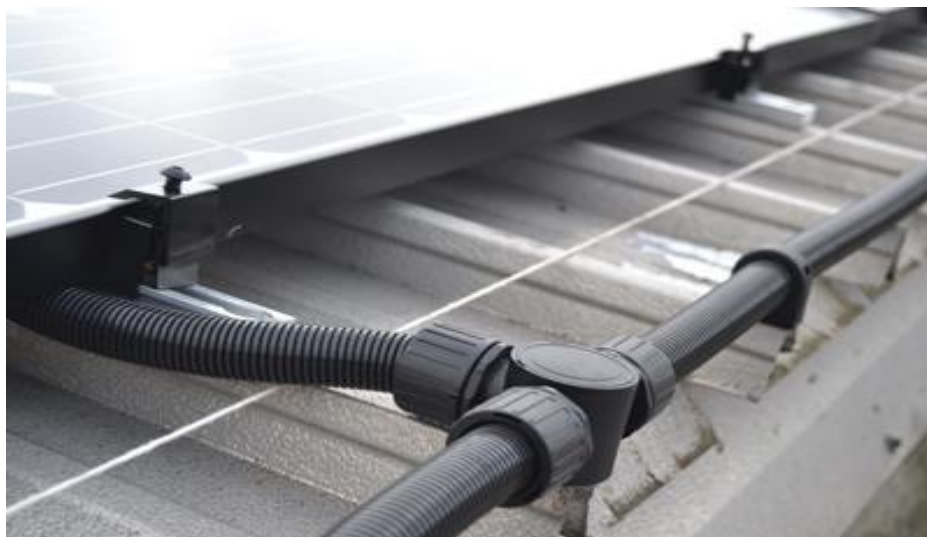
Εικόνα 47. Προστασία καλωδιώσεων φωτοβολταϊκών σε κανάλια (Πηγή: www.solarbuildermag.com 27 )
