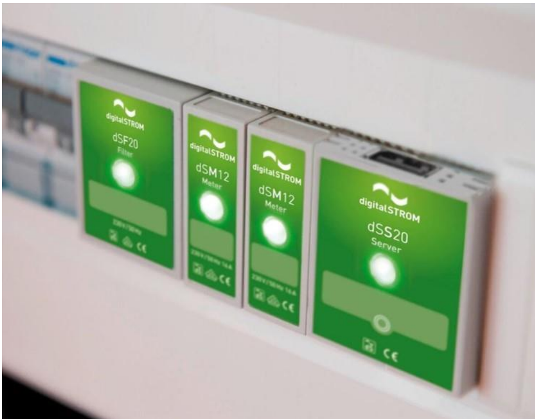
Εικόνα 28: Συσκευές (φίλτρα, meters, server) που τοποθετούνται στον πίνακα
