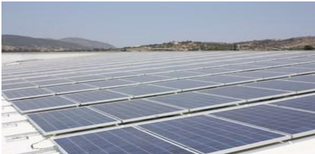
Εικόνα 1.10:Εγκατάσταση φωτοβολταϊκού σε βιομηχανική στέγη στο ΒΙΟΠΑ Κερατέας 99,8 kw ( https://www.georvthmiki.gr )
