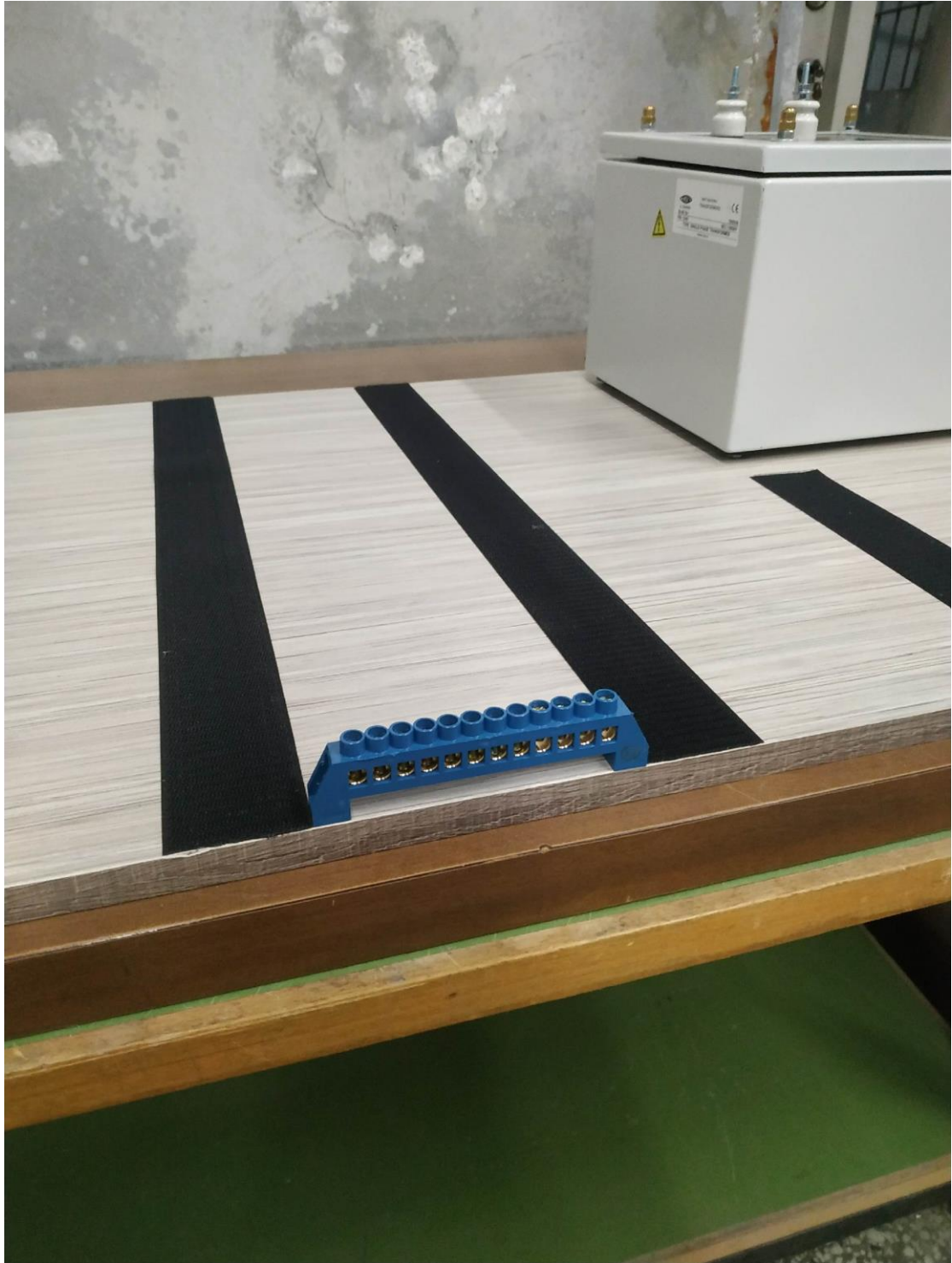
Εικόνα 3.1.2 Μονομένη μπάρα χαλκού βιδωμένη στη βάση. Στα δεξιά φαίνεται ο μετασχηματιστής δοκιμής τοποθετημένος στην θέση του.
