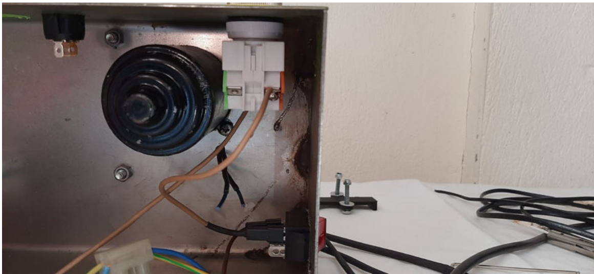
Εικόνα 88 : Συνδεσμολογία τροφοδοσίας στον γενικό διακόπτη έπειτα στο emergency stop και τέλος στο τροφοδοτικό.
