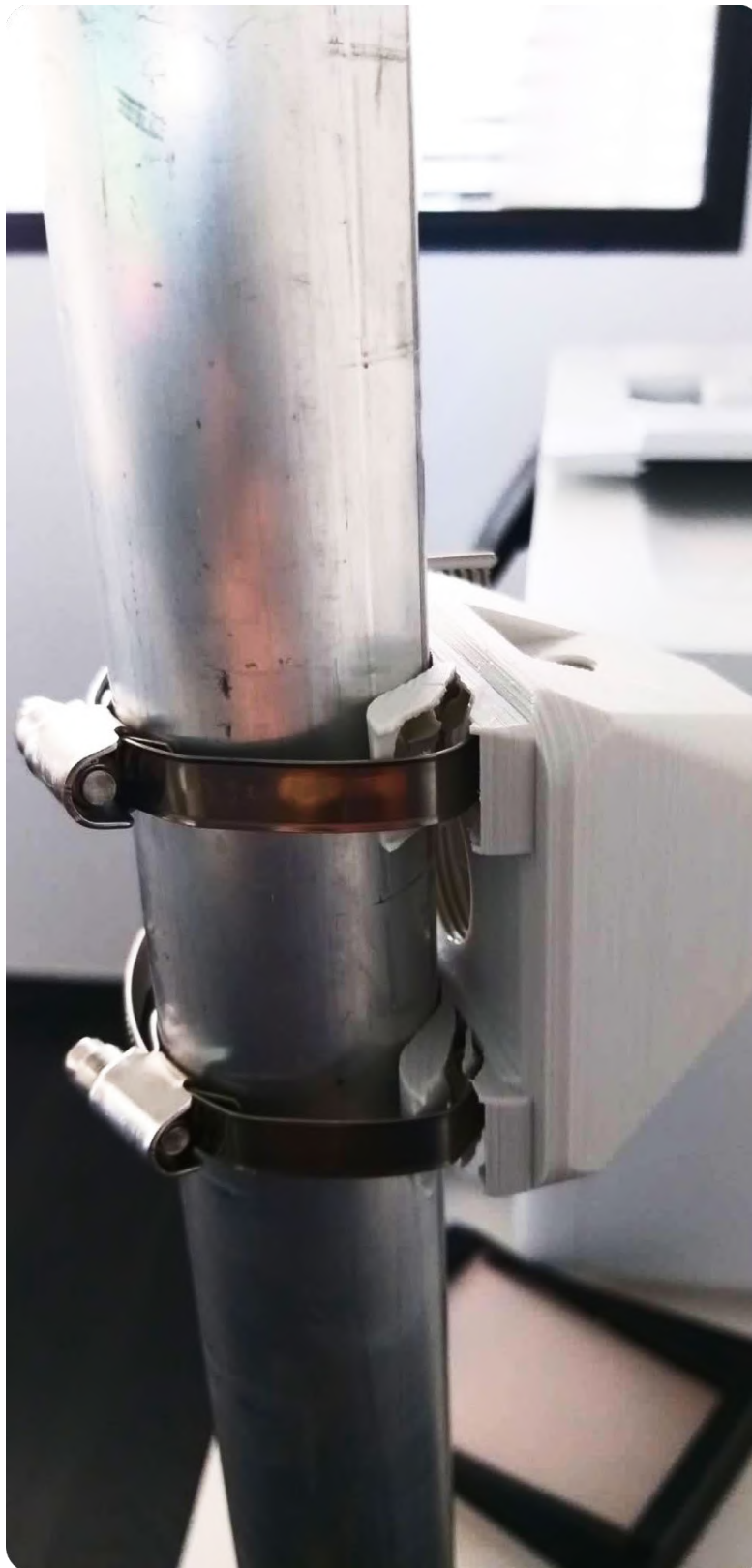
Εικ 135. Απεικόνιση περιβλήματος αισθητήρα στάθμης υδάτων μετά από υπερβολική φόρτιση των σφικτήρων. Παρατηρείται θραύση στα προβλεπόμενα σημεία
