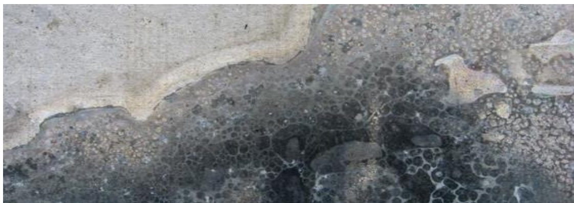
Εικόνα 20: Πλάκα αλουμινίου υπό διάβρωση
