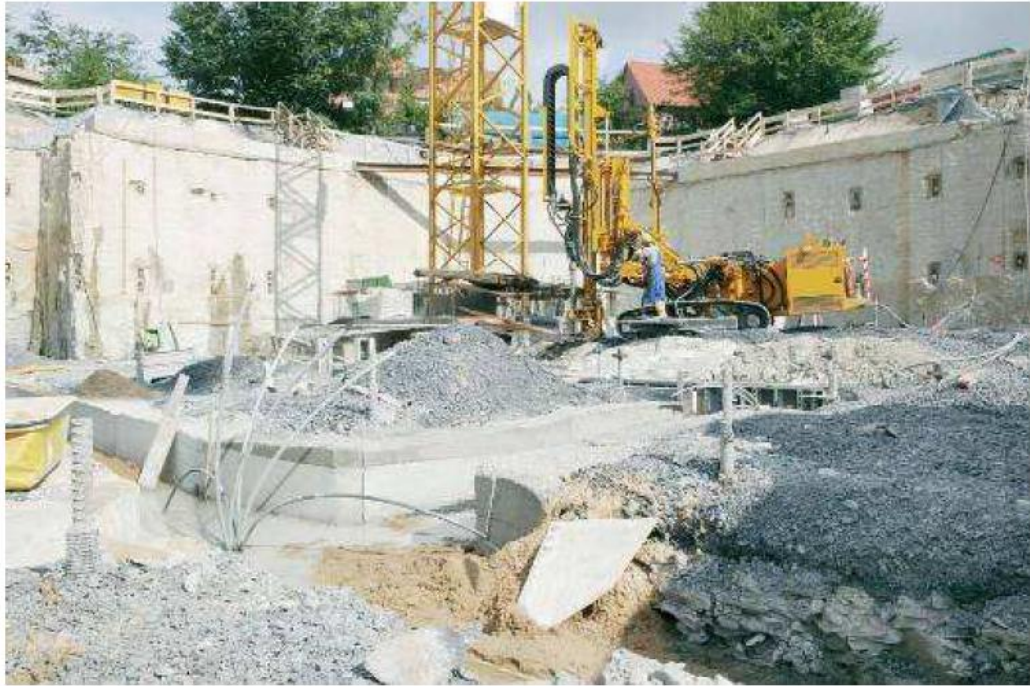
Σχήμα 5.17 : Γεώτρηση (Πηγή: REHAU)
