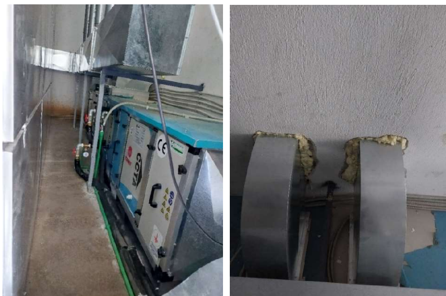
Εικόνα 5.17 και 5.18 Σύστημα HVAC
