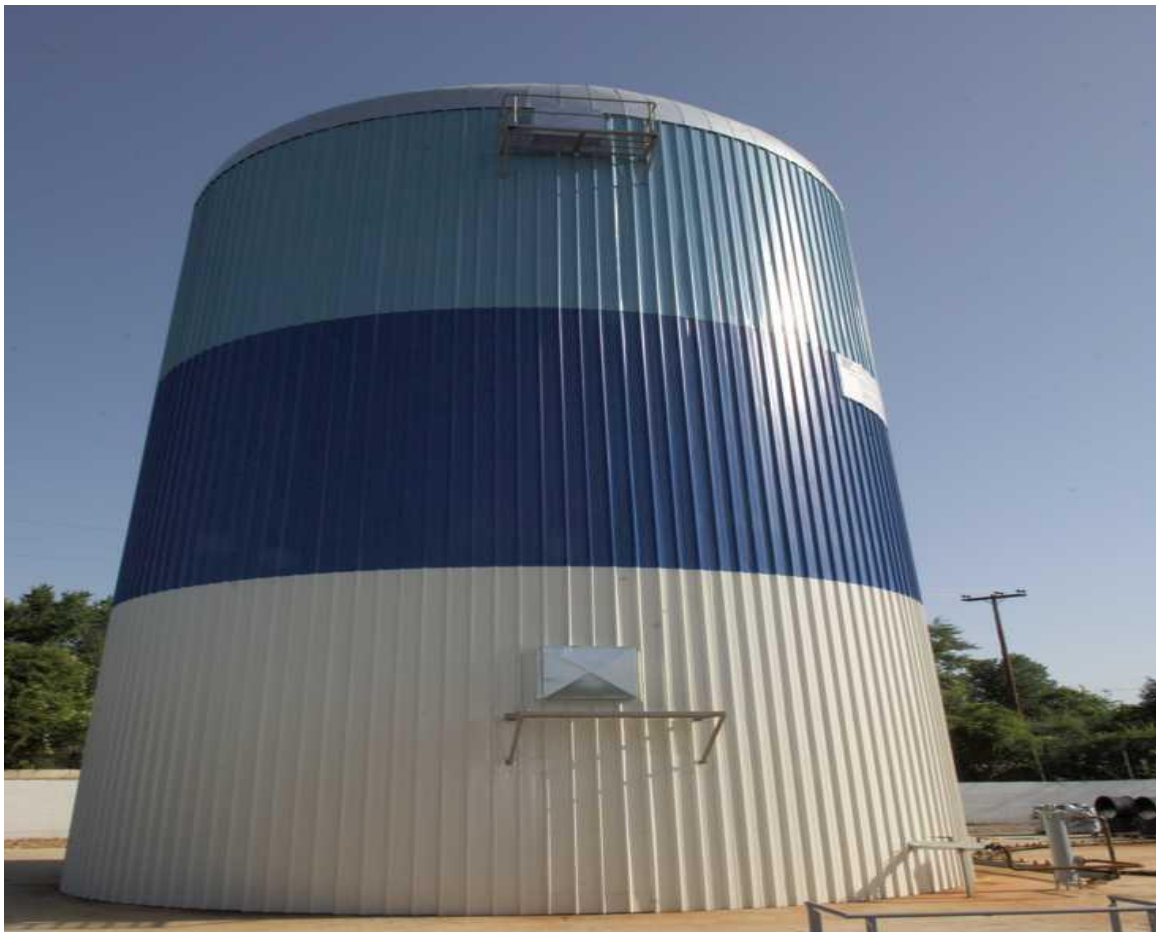
Εικόνα 22: Θερμοδοχείο εναποθήκευσης τηλεθέρμανσης Κοζάνης 21
