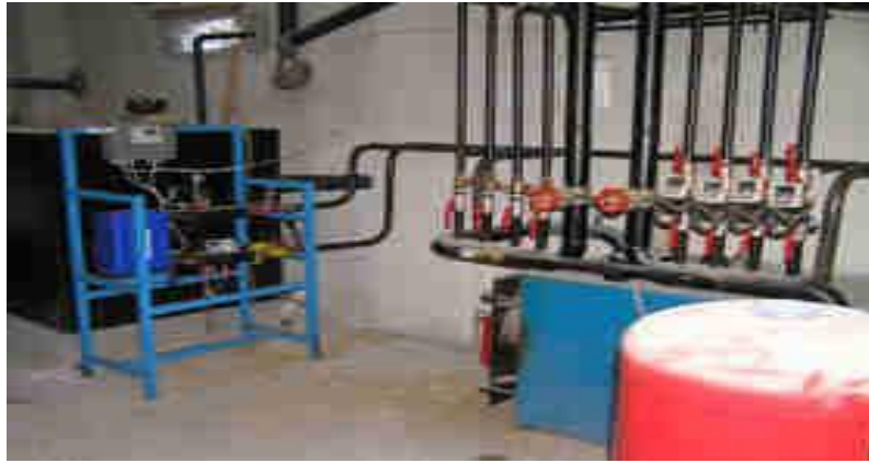
Εικόνα 5: Τυπικός θερμικός υποσταθμός καταναλωτή 5
