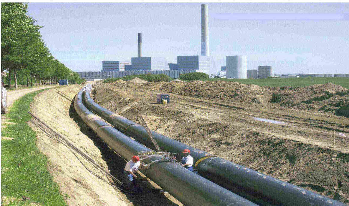
Εικόνα 4: Δίκτυο μεταφοράς θερμού μέσω του συστήματος τηλεθέρμανσης 4
