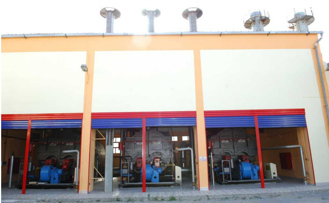
Εικόνα 21: Εφεδρικοί λέβητες τηλεθέρμανσης Κοζάνης 20
