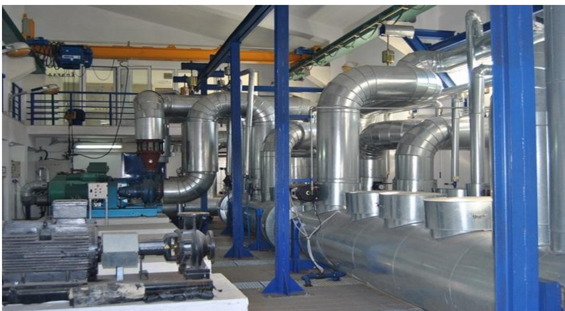
Εικόνα 7: Κεντρικό Αντλιοστάσιο – Τηλεθέρμανση Αμυνταίου 11
