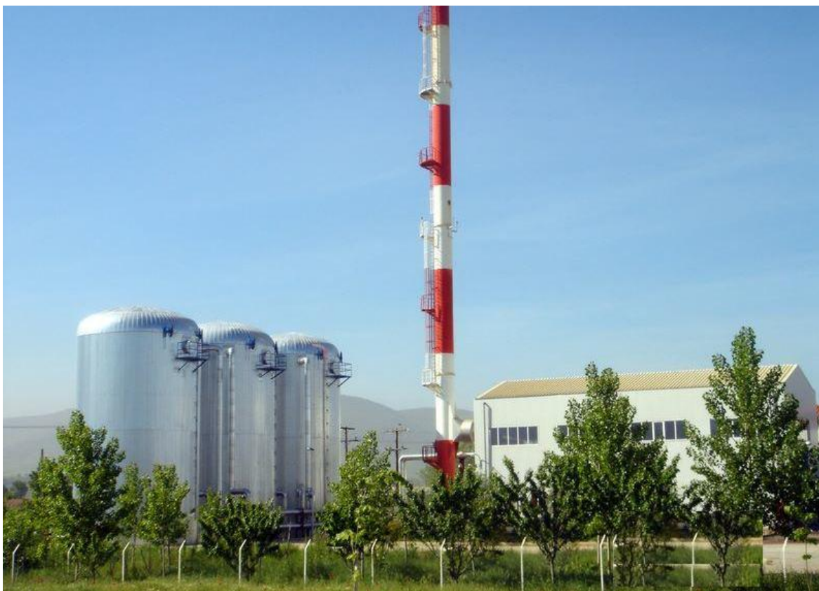
Εικόνα 2: Δεξαμενές αποθήκευσης θερμικής ενέργειας 2
