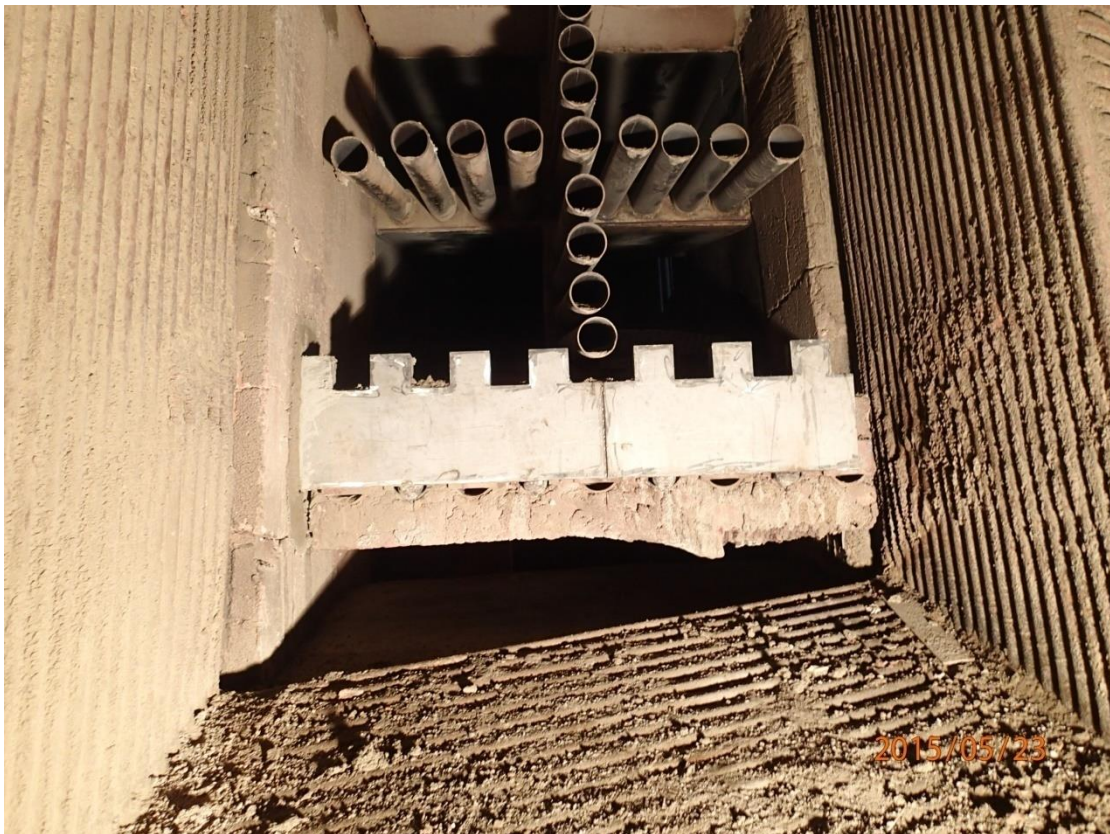
Σχήμα 3.28: Μεταλλική πλάκα αναχαίτησης σωματιδίων λιγνίτη [6]
