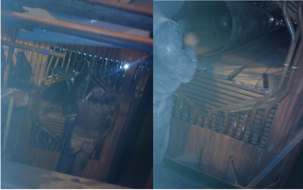
Σχήμα 3.26: Οι νέοι διαμορφωμένοι αυλοί κατά τη συγκόλλησή τους στο υδροτοίχωμα του λέβητα [6]
