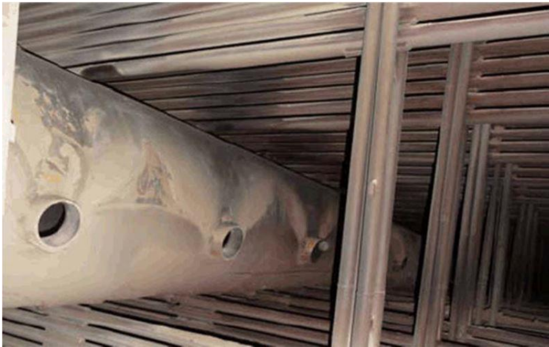
Σχήμα 2.5: Όψη μια λόγχης που είναι τοποθετημένη στον υπερθερμαντή [10]
