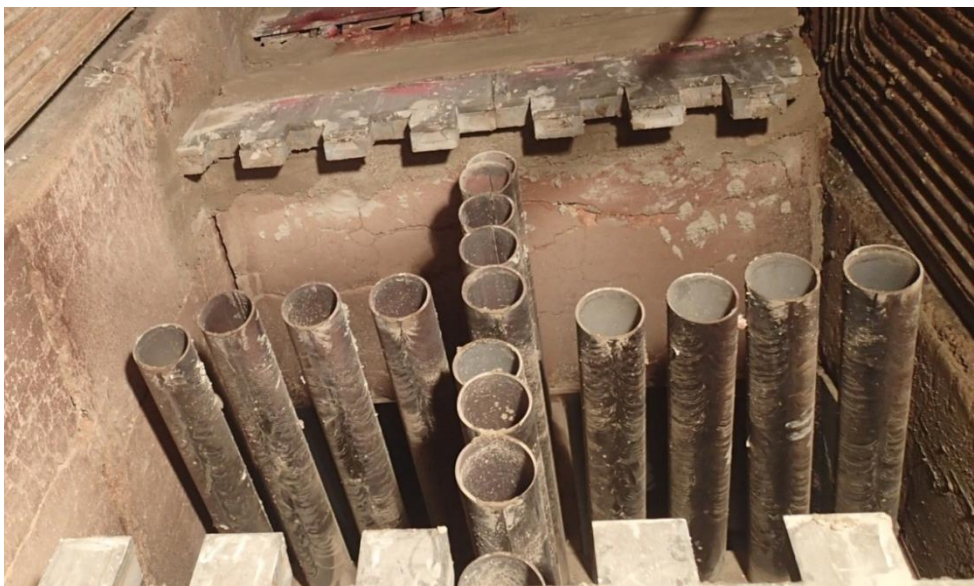
Σχήμα 2.13: Πυροβόλα καυστήρων Μονάδας V μετά την μετασκευή [6]
