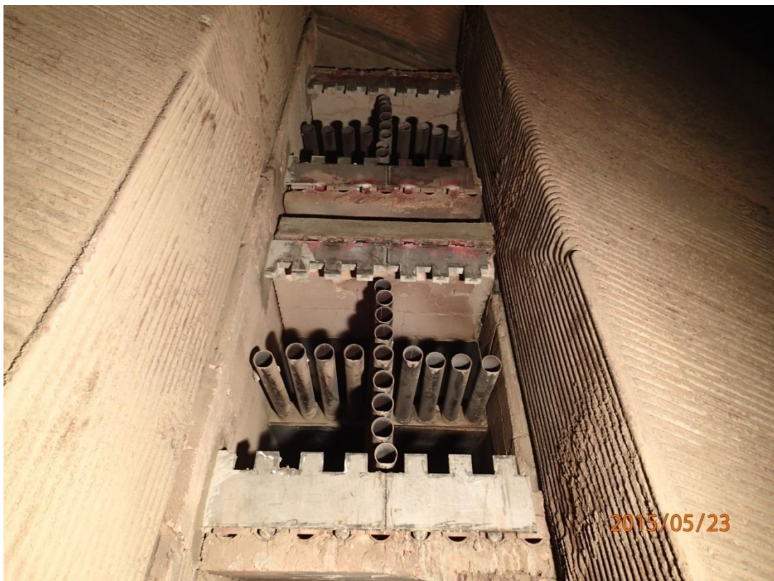
Σχήμα 3.30: Καυστήρας μονάδας V μετά την μετασκευή [6]
