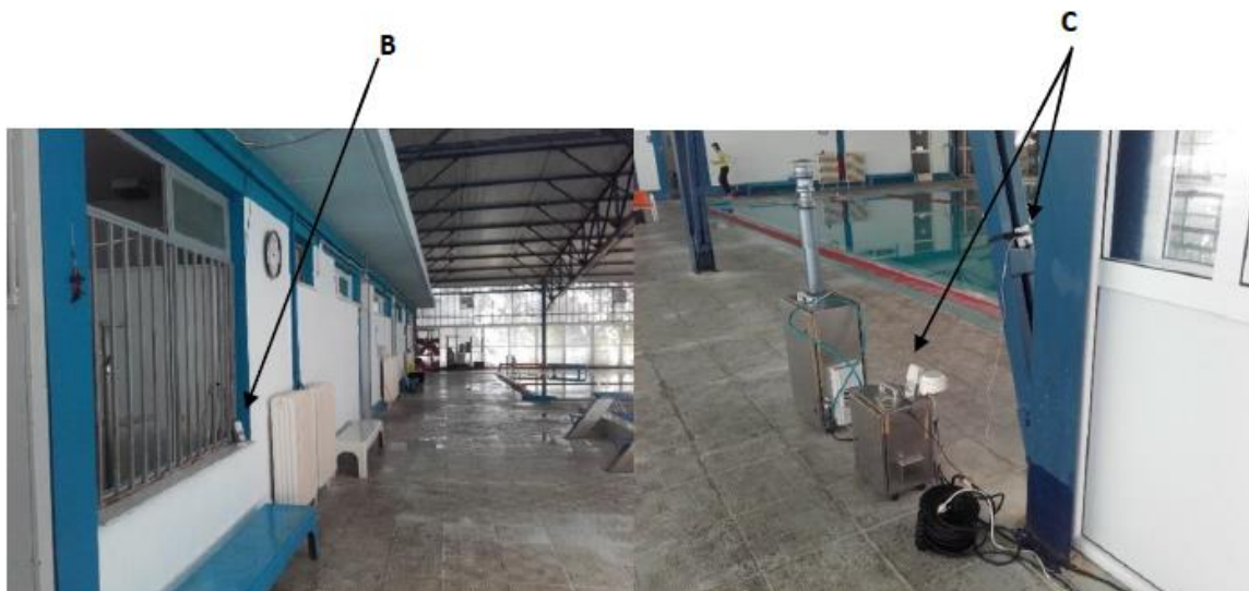
Εικόνα 4.5: Αισθητήρες θερμοκρασίας, υγρασίας και CO 2 (Αισθητήρες B,C)
