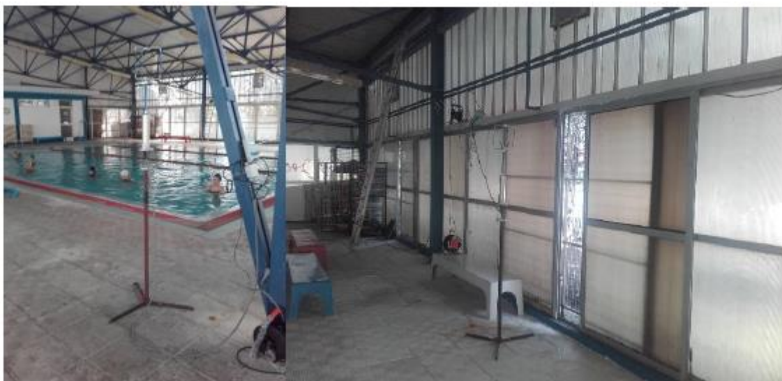
Εικόνα 4.6: Εγκατεστημένο ανεμόμετρο σε κεντρική θέση (2) και NA(4α)
