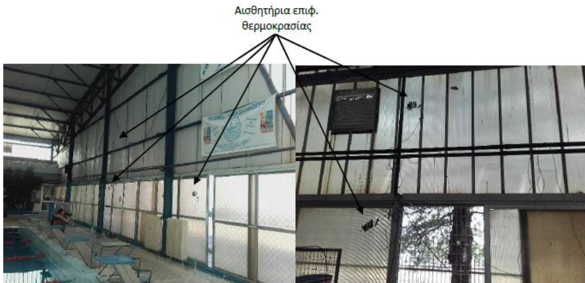
Εικόνα 4.7 : Εγκατεστημένα αισθητήρια επιφανειακής θερμοκρασίας
