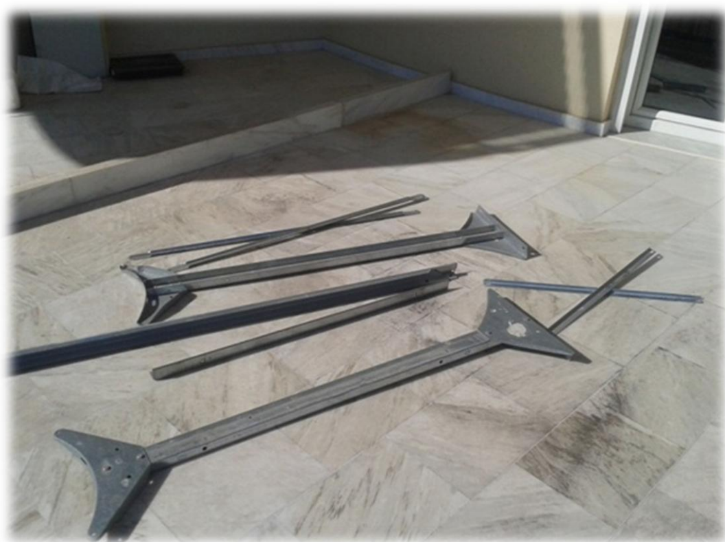
Εικόνα 3.1: Μεταλλικοί ράβδοι που συνθέτουν την βάση στήριξης του ηλιακού θερμικού συστήματος.
