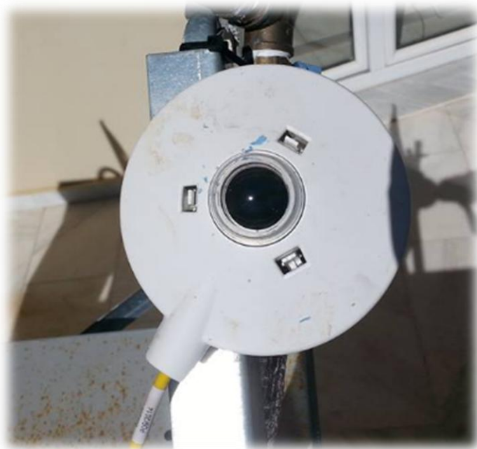
Εικόνα 3.35: Πυρανόμετρο τοποθετημένο σε ίδια κλήση με αυτή του συλλέκτη.
