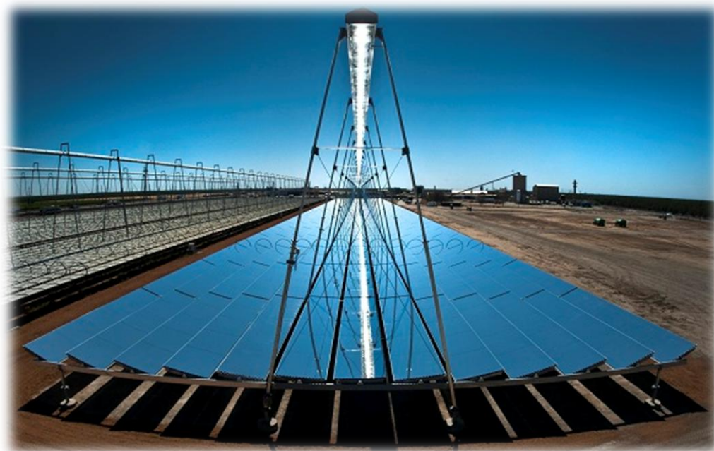
Εικόνα 1.8: Σταθμός συλλεκτών Fresnel.[5]
