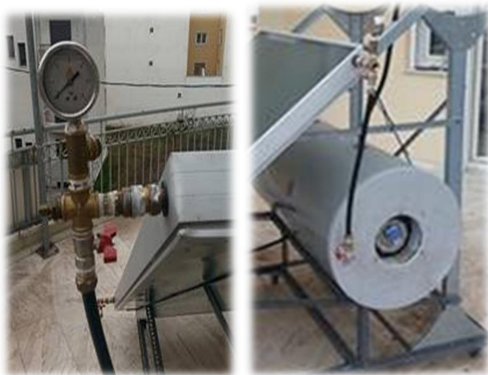
Εικόνες 3.23 – 3.24: Έξοδος ρευστού απολαβής από τον ηλιακό θερμικό συλλέκτη και είσοδος στην δεξαμενή αποθήκευσης.
