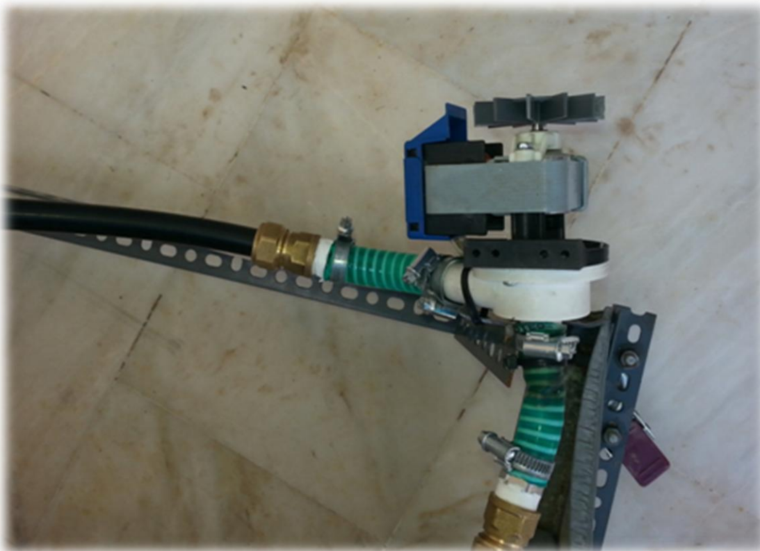
Εικόνα 3.31: Αντλία ανακυκλοφορίας του νερού χρήσης εντός της δεξαμενής αποθήκευσης.
