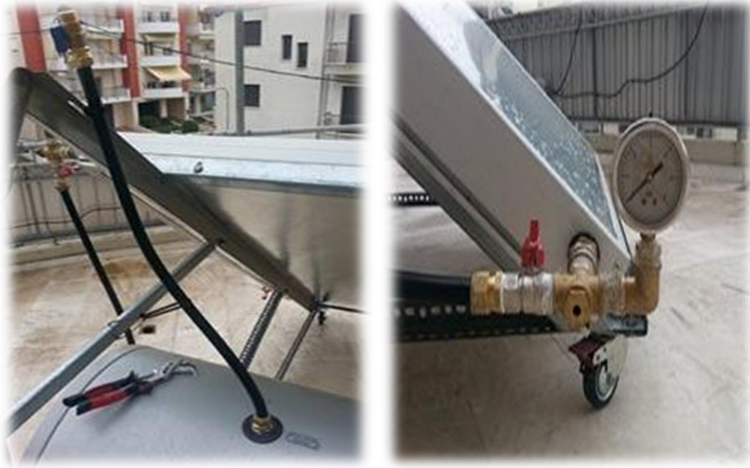
Εικόνες 3.21 – 3.22: Είσοδος του ρευστού απολαβής στην δεξαμενή (αριστερά) το οποίο οδηγείται στην είσοδο του συλλέκτη (δεξιά).
