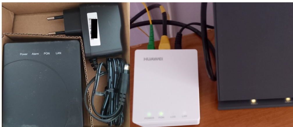
Εικόνα 25. Εξοπλισμός/Εργαλεία 2: PONS εγκαταστάσεων οπτικής ίνας
